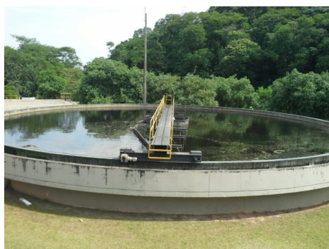
Vista Geral do Decantador.
