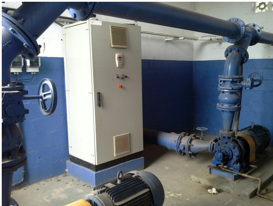
Conjunto de Bombas da Elevatória.
