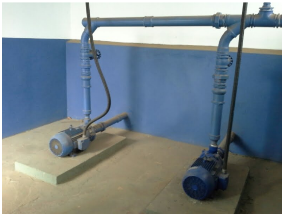
Conjunto de Bombas da Elevatória.
