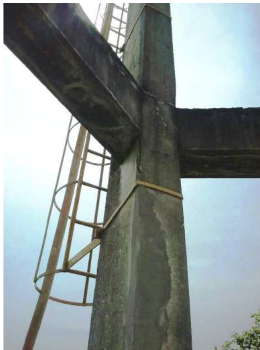
Descrição(3): Estrutura em concreto armado da base do Reservatório 5 com muitas fissuras e trincas cujas patologias do concreto necessitam de reparos para resolver as infiltrações da água de chuva que atingem a armadura de aço oxidando-a e deixando-as comprometida.
