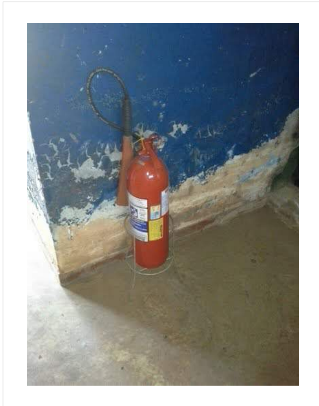
Descrição(3): Extintor de incêndio instalado
