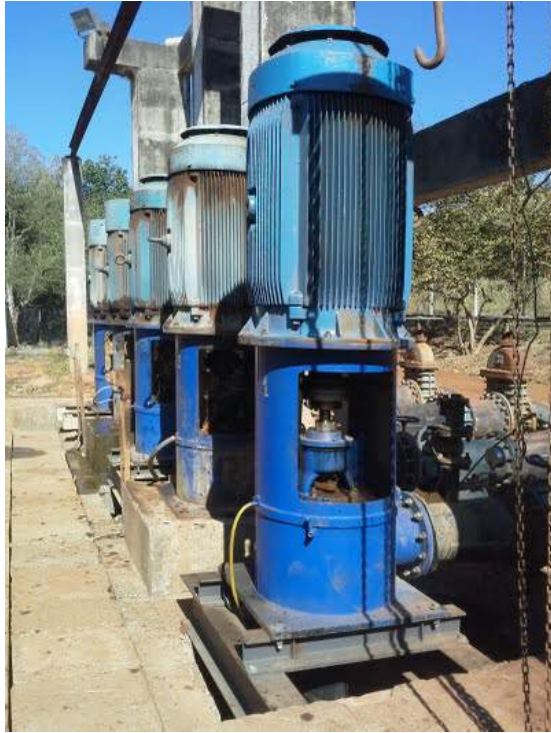
Descrição(2): Conjuntos de recalque
