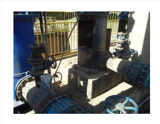
Descrição(4): Manômetros instalados nos conjuntos de recalque
