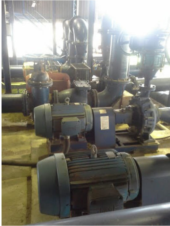
Descrição(2): Conjuntos de recalque para bairros Cruzeiro do Sul, Vale das Cigarras e Dona Margarida
