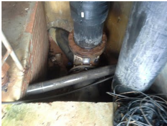
Descrição(3): Vazamento interno
