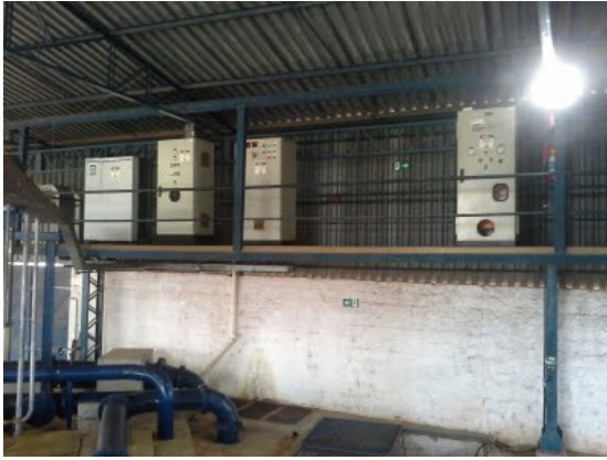
Descrição(6): Paineis elétricos
