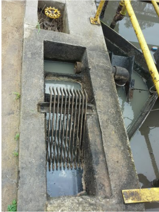
Descrição(3): Gradeamento grosso e caixa de distribuição
