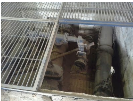
Descrição(8): Valvulas de alívio e medidor de vazão
