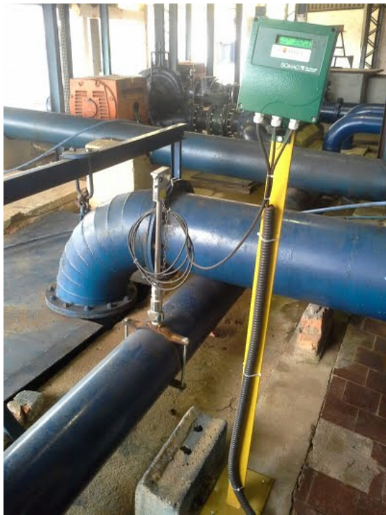
Descrição(5): Medidor de vazão para reservatório elevado
