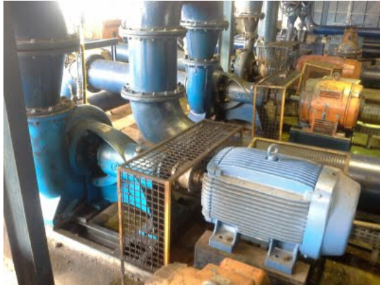
Descrição(4): Conjuntos de recalque para reservatório Vila Brasil
