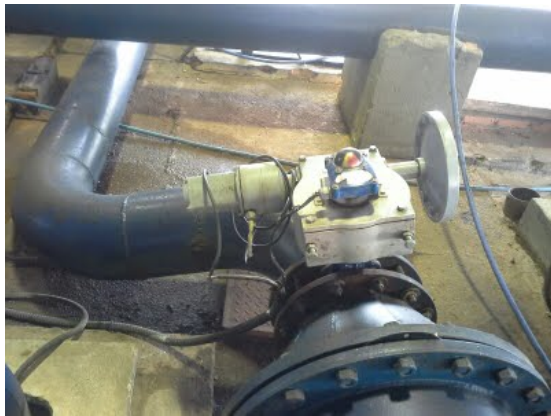
Descrição(3): Atuador elétrico para reservatório elevado
