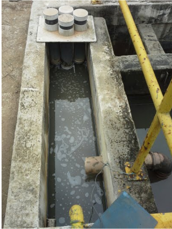
Descrição(5): Saída do efluente dos tanques de aeração e desinfecção com Hipoclorito de Cálcio
