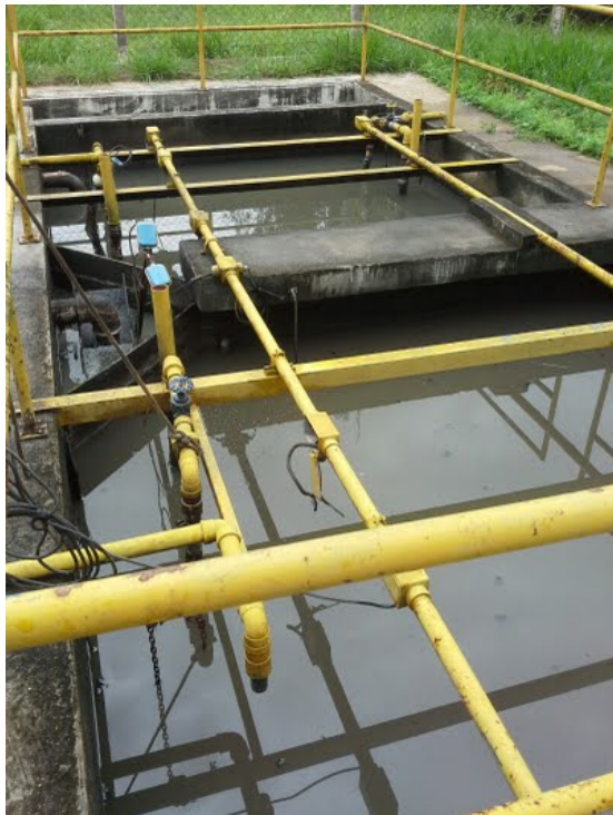
Descrição(4): Tanques de aeração
