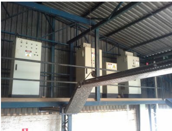
Descrição(7): Paineis elétricos
