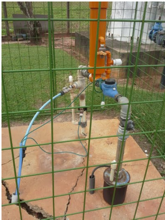
Descrição(2): Laje de proteção, tubo para medição de nível, hidrômetro, clorador por pastilhas de Ácido Tricloroisocianurico e fluoretação por bomba dosadora
