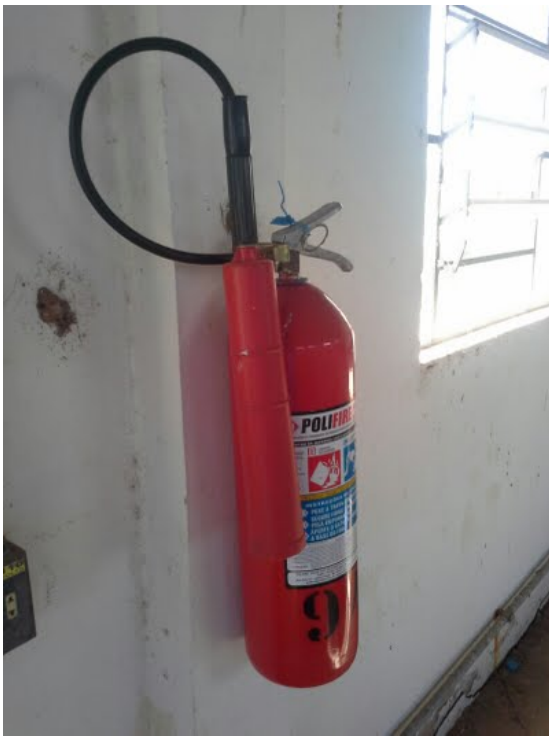
Descrição(3): Extintor de incêndio
