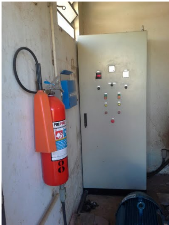
Descrição(2): Extintor de incendio e painel elétrico
