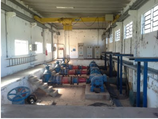
Descrição(2): Conjuntos de recalque
