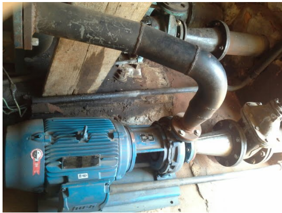
Descrição(5): Detalhes das instalações de um conjunto moto-bomba
