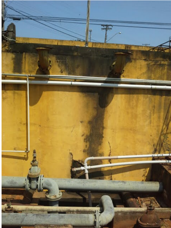
Descrição(5): Detalhes do barrilete de distribuição e dos tubos extravasores.
