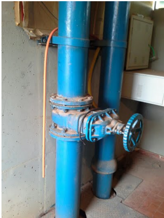
Descrição(3): Detalhes do barrilete de saída do reservatório elevado de concreto para a distribuição por gravidade
