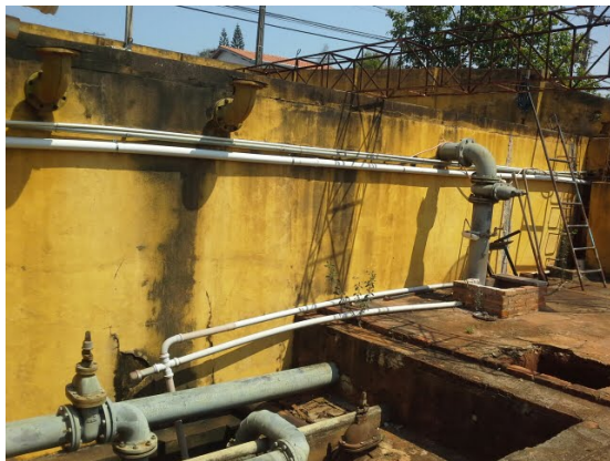
Descrição(6): Vista completa dos diversos equipamentos hidráulicos.
