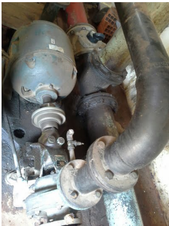
Descrição(6): Detalhes do outro conjunto moto-bomba
