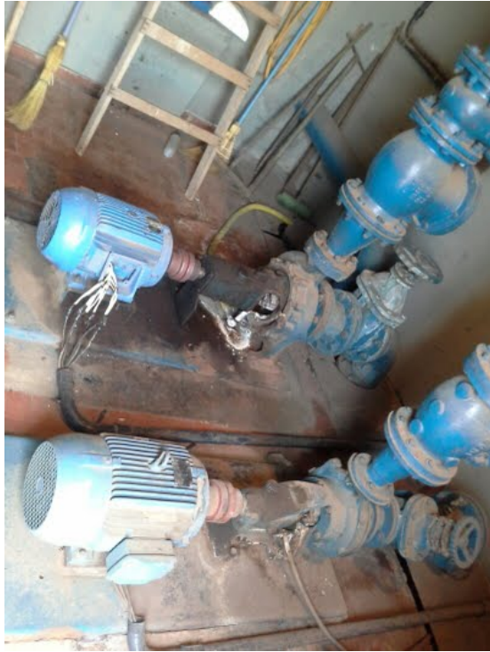
Descrição(2): Conjuntos moto-bombas de recalque da EEAT - Recalque 3
