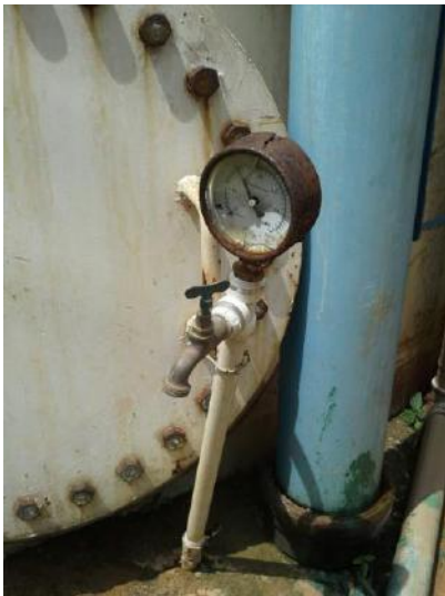
Manômetro do reservatório
