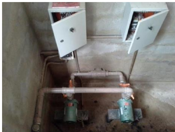
Aspecto interno da elevatória
