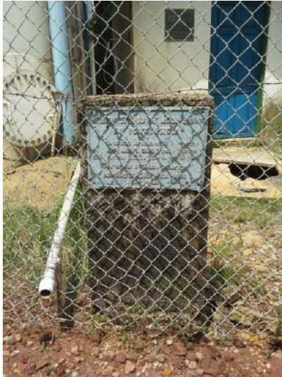
Placa de identificação do reservatório
