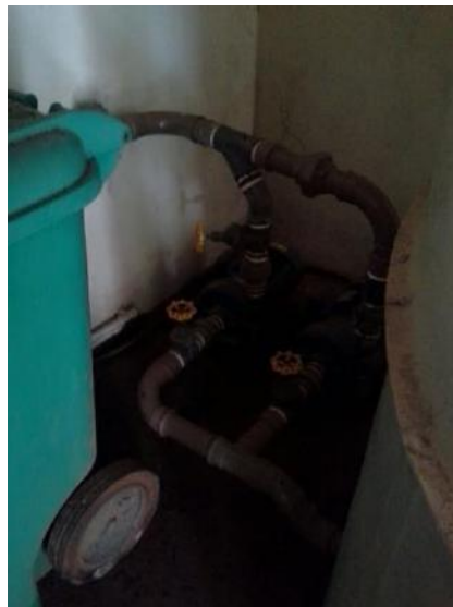
Aspecto interno da elevatória
