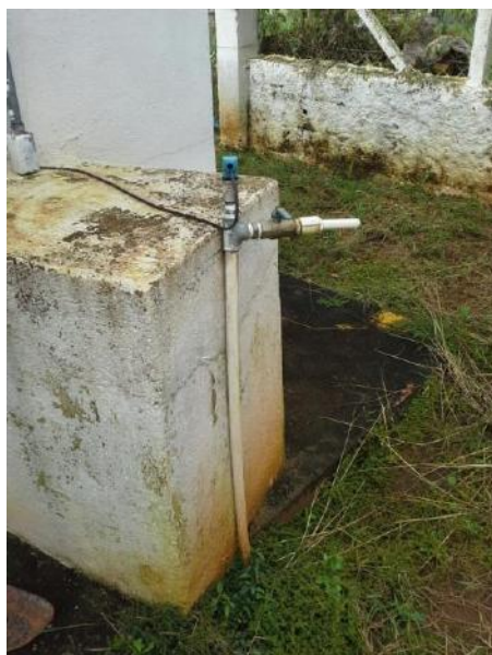
Ponto de tomada de água
