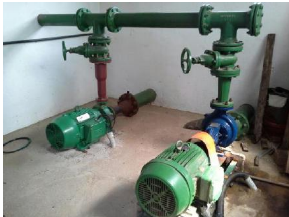
Aspecto interno da elevatória
