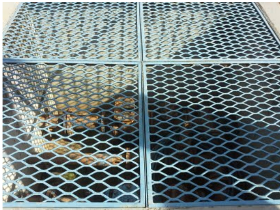
Descrição(4): Barrilete de saída
