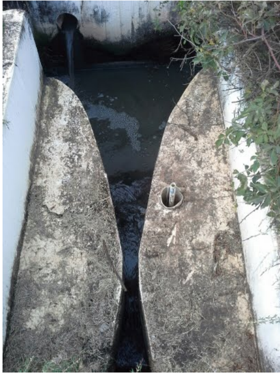
Descrição(3): Chegada do esgoto bruto
