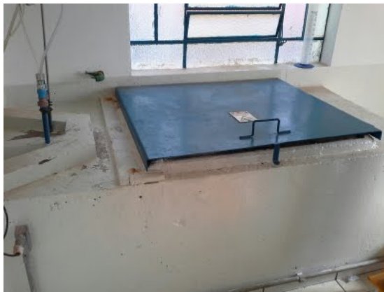
Descrição(4): Tanque de contato
