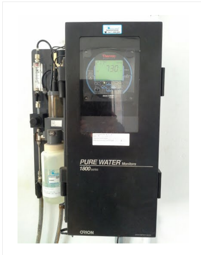
Descrição(5): Analisador on-line de Flúor
