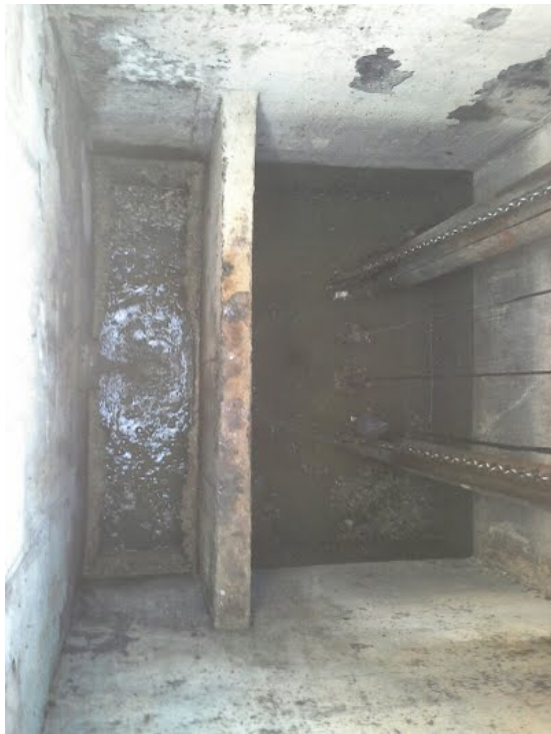
Descrição(3): Chegada do esgoto bruto e poço de sucção
