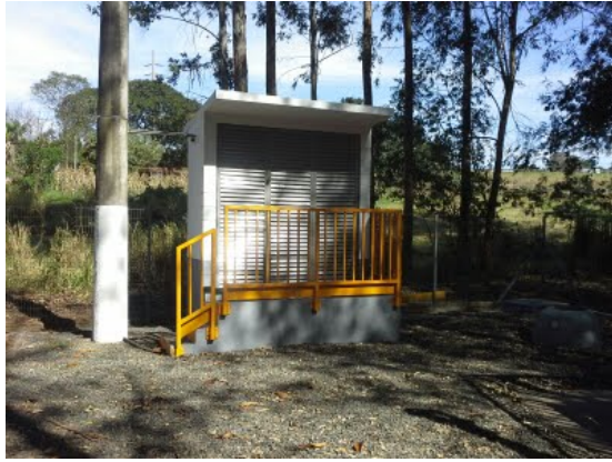
Descrição(3): Cabina elétrica
