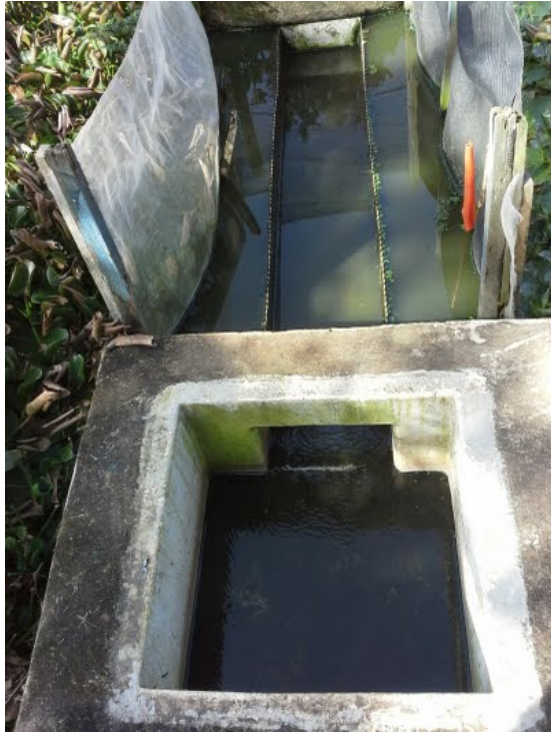
Descrição(5): Saída do efluente tratado
