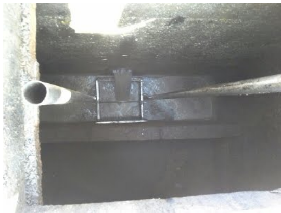
Descrição(4): Chegada do esgoto bruto e gradeamento grosseiro
