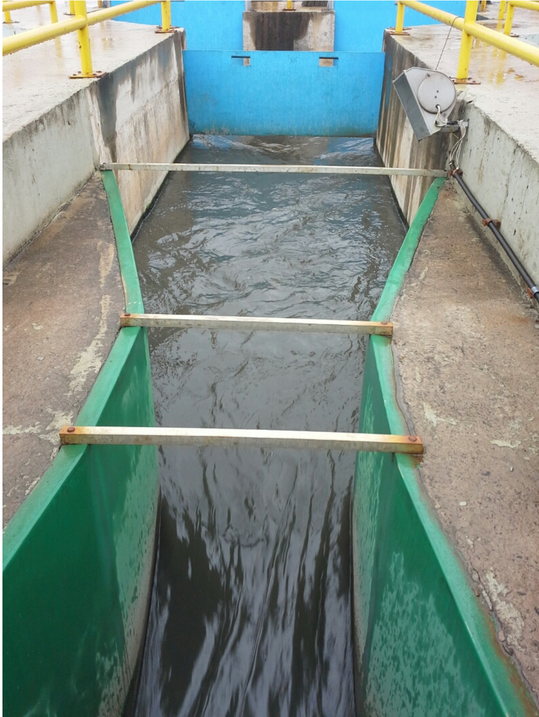
Descrição(3): Entrada do esgoto bruto
