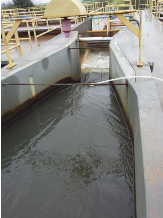
Descrição(2): Chegada da água bruta
