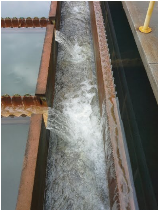
Descrição(3): Saída dos decantadores
