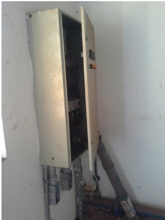
Descrição(2): Painel elétrico EEAB
