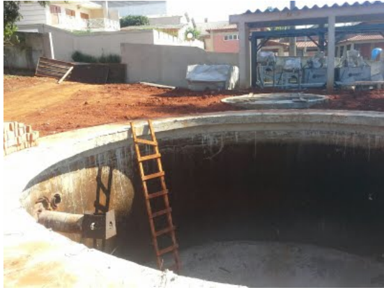
Descrição(3): Obras paralizadas "casa de lodo"
