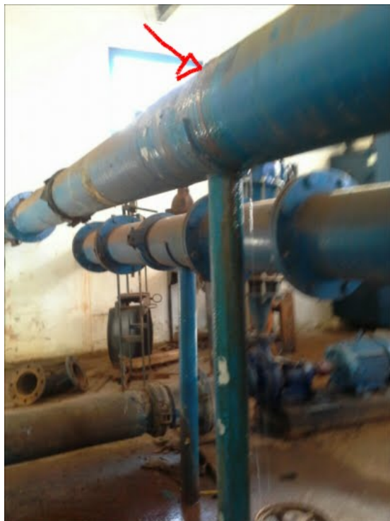
Descrição(2): Detalhe vazamento
