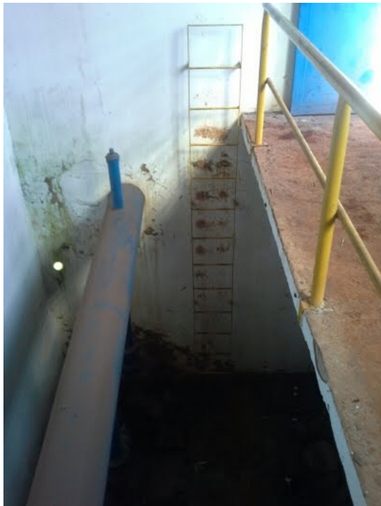
Descrição(3): Ausência guarda corpo
