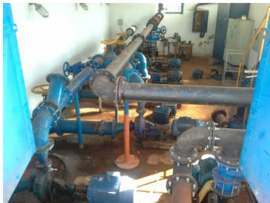
Descrição(3): EEAT casa de bombas
