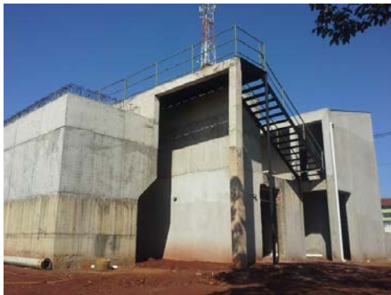
Descrição(4): Obras paralizadas ampliação ETA
