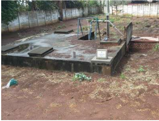
Descrição(2): Vista geral do poço de sucção de esgoto EEEB
