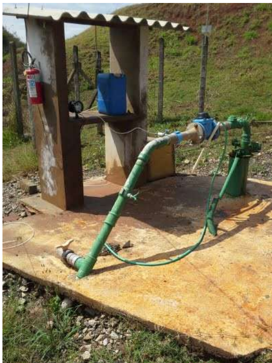
Descrição(3): Vista geral do poço 06, completo de equipamentos exceto dosador de flúor.
