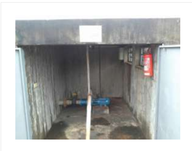
Descrição(4): Vista geral interna à casa de bombas
