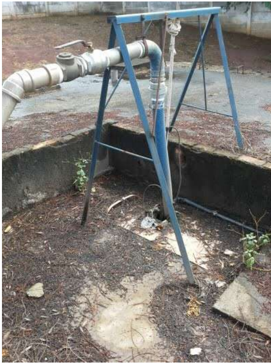
Descrição(3): Detalhe do cavalete de suporte da motobomba submersa
