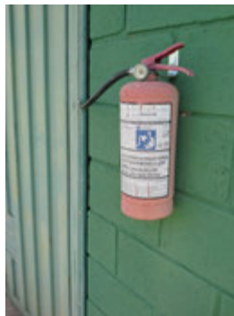
Descrição(6): Extintor de incêndio com carga fora do prazo de validade
