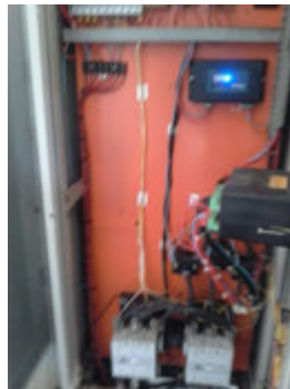
Descrição(13): Painel Elétrico de Comando da telemetria Imagem(14)
