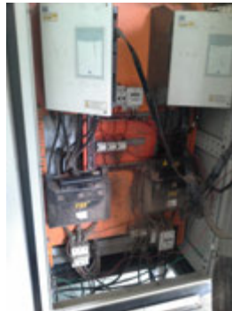
Descrição(12): Interior do Painel Elétrico com Inversores de frequência Imagem(13)
