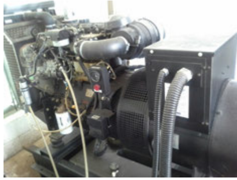
Descrição(4): Detalhes do conjunto motobomba gerador de energia elétrica
