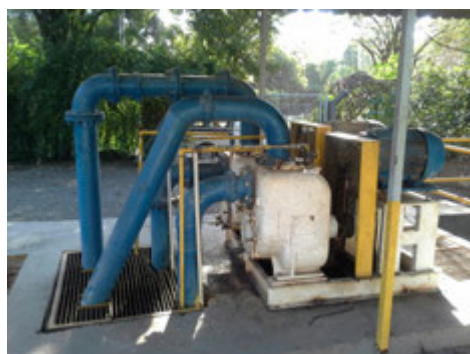
Descrição(6): Conjuntos motobombas com barriletes de sucção e de recalque do esgoto bruto
