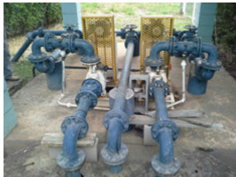
Descrição(7): Conjuntos motobombas sob uma cobertura com as laterais totalmente abertas
