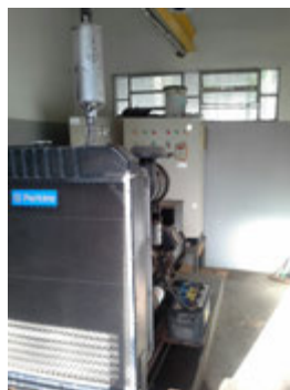
Descrição(14): Outra vista da casa do gerador e do painel de comando elétrico dos conjuntos motobombas
