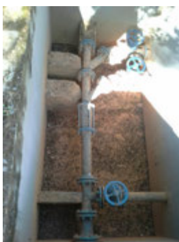
Descrição(5): Barrilete de recalque com válvula de retenção e registros de manobras das vazões de saída Imagem(6)
