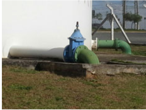
Descrição(4): Tubulações de saída e de descarga de fundo
