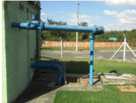
Descrição(9): Vista do barrilete de sucção e dos poços de sucção e de entrada do esgoto bruto
