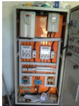
Descrição(6): Interior do Painel Elétrico com soft starter
