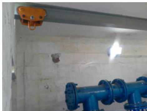
Descrição(7): Detalhe da estrutura metálica da monovia com talha para sacar os conjuntos motobombas para a manutenção
