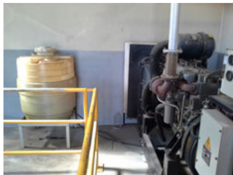
Descrição(9): Gerador de energia elétrica à diesel
