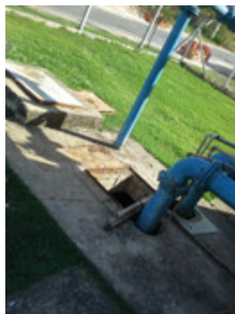
Descrição(11): Detalhe do poço de sucção sem a grade metálica da tampa que está enferrujada
