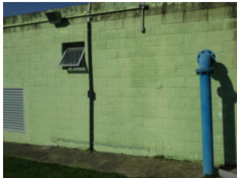
Descrição(10): Casa de bombas com o detalhe da saída da tubulação para o recalque do esgoto bruto para a ETE
