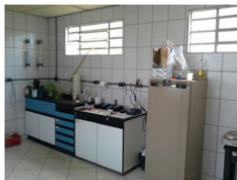
Descrição(7): Laboratório de análises químicas para monitoramento da água tratada dos parâmetros mínimos de 2 em 2 horas da ETA 4
