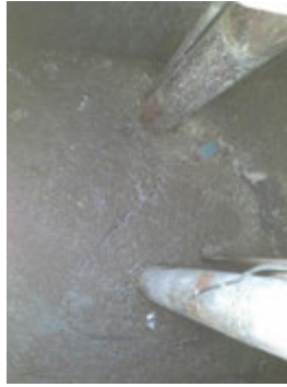
Descrição(8): Poço de sucção aspirada do esgoto bruto
