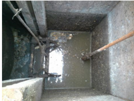
Descrição(5): Poço com o cesto de gradeamento e a comporta Imagem(6)
