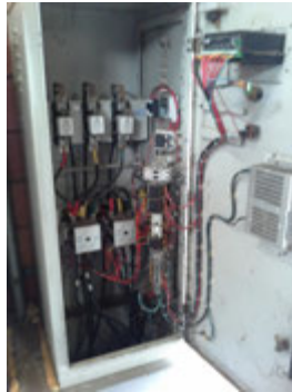
Descrição(4): Interior do Painel Elétrico da chsve geral da entrada de energia
