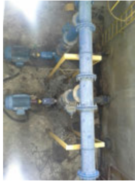
Descrição(10): Conjuntos motobombas com barriletes de recalque Imagem(11)
