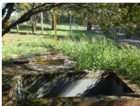
Descrição(4): Vista geral das caixas de inspeção e poços da EEE Imagem(5)
