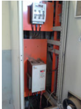
Descrição(7): Interior do Painel Elétrico com soft starter
