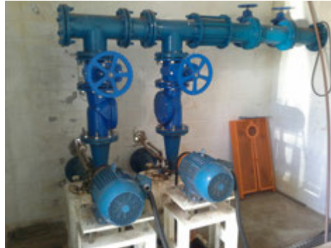
Descrição(5): Conjuntos motobombas com barriletes de sucção e de recalque do esgoto bruto com registros de manobras das vazões e válvulas de retenção
