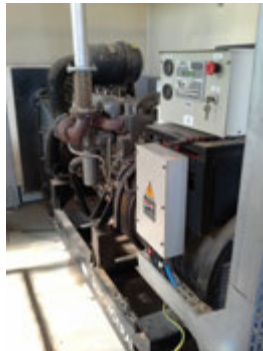
Descrição(8): Gerador de energia elétrica à diesel
