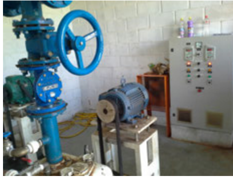
Descrição(4): Detalhe do barrilete de recalque com válvula de retenção e registros de manobras das vazões e painel de comando elétrico dos conjuntos motobombas
