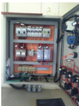
Descrição(3): Interior do Painel Elétrico com proteção convencional simples dos conjuntos motobombas Imagem(4)
