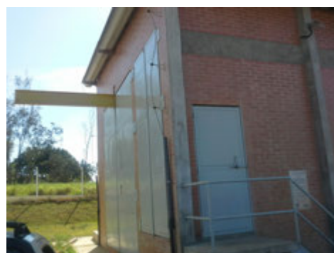
Descrição(11): Casa de bombas com a monovia com talha para sacar os conjuntos motobombas para a manutenção
