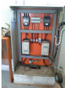
Descrição(5): Interior do Painel Elétrico com soft starter
