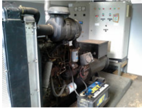
Descrição(11): Gerador de energia elétrica à diesel e painel elétrico de comando Imagem(12)
