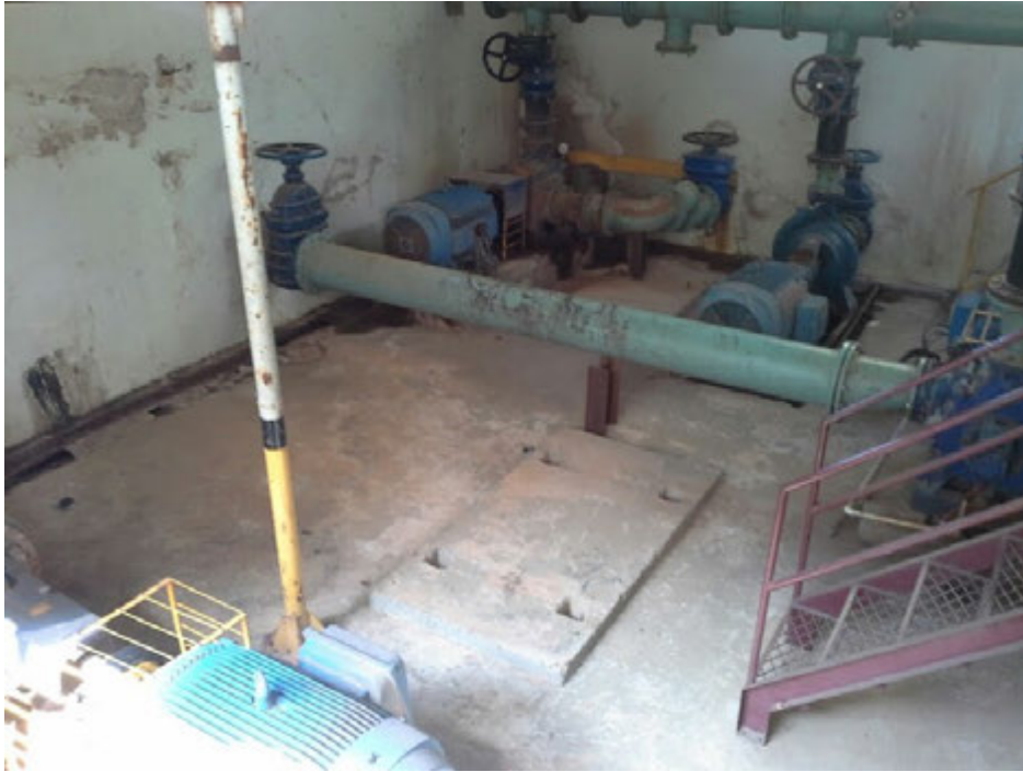
Descrição(2): Conjuntos de recalque
