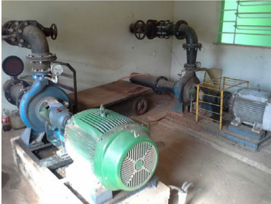
Descrição(2): Conjuntos de recalque
