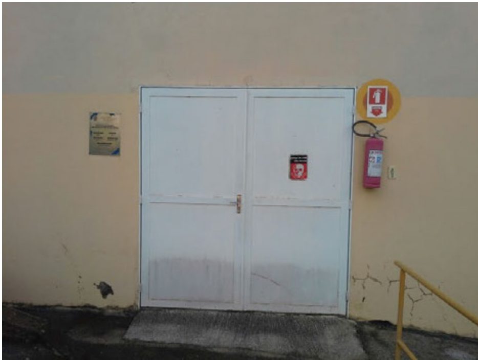
Descrição(3): Cabina elétrica
