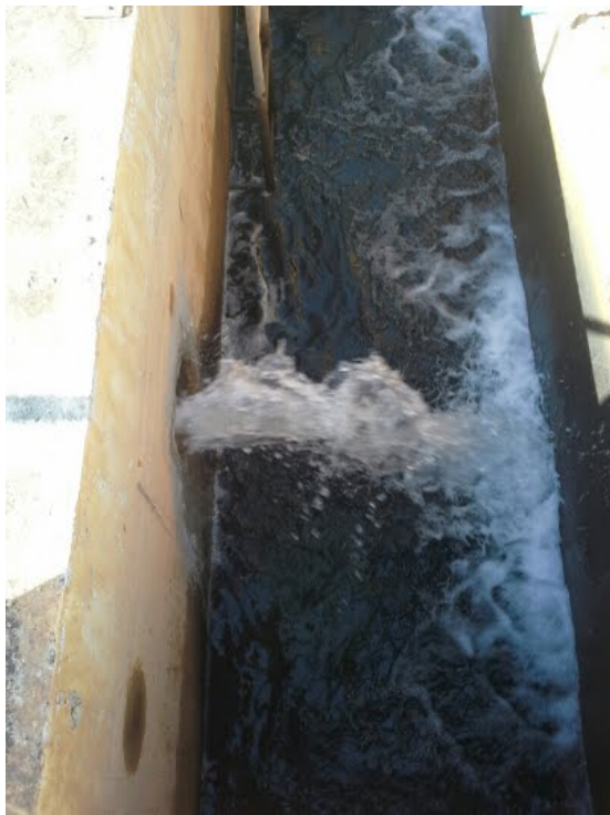
Descrição(6): Saída decantador
