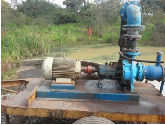
Descrição(2): Conjunto de recalque da captação
