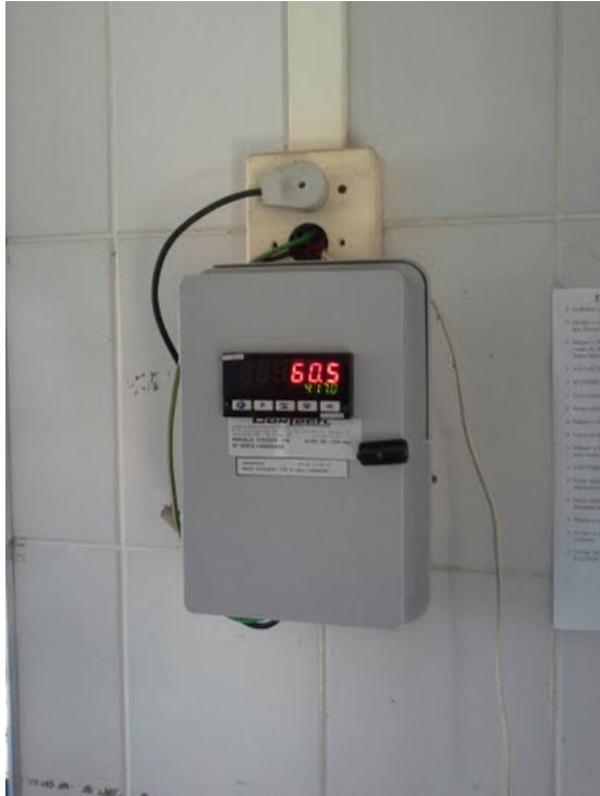
Descrição(16): Medidor de vazão novo
