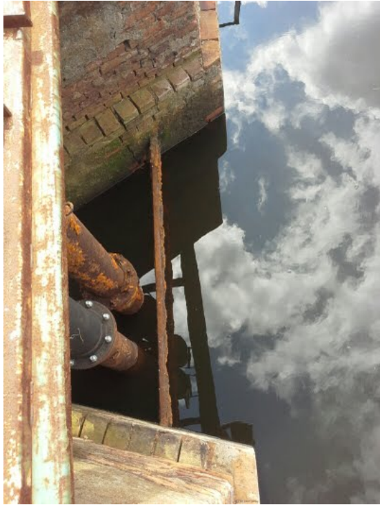
Descrição(4): Detalhe sucção
