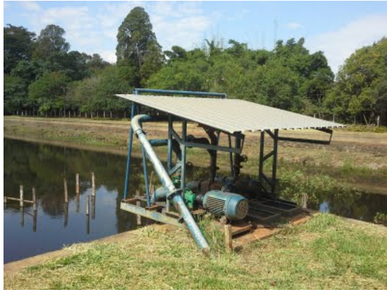
Descrição(2): Conjuntos recalque
