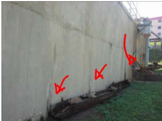
Descrição(20): Detalhe de fissuras na ETA
