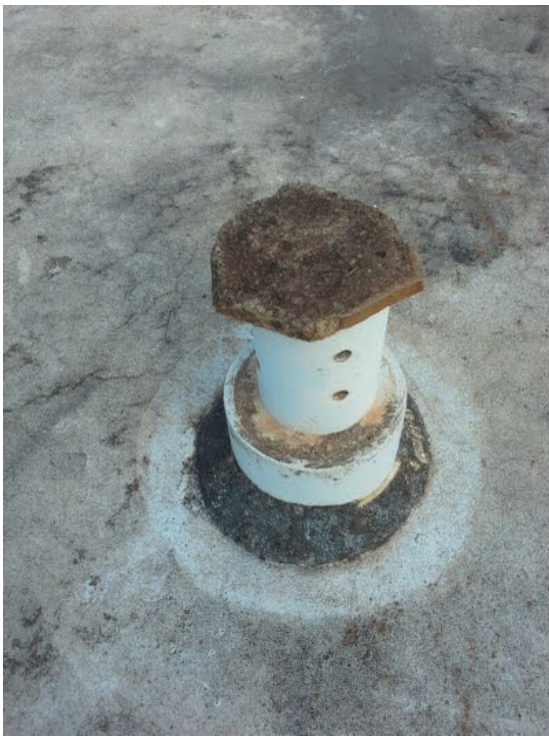
Descrição(4): Detalhe "respiro " ( retirar essa "estrutura" e colocar tela de proteção )
