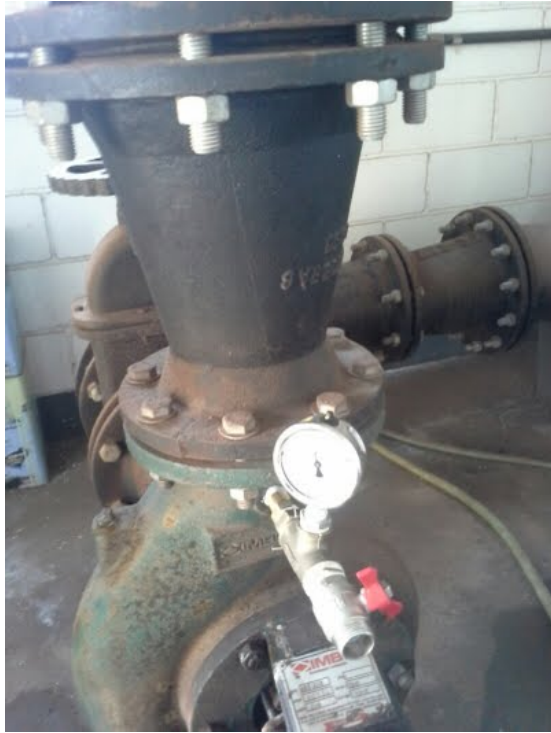
Descrição(2): Manômetros instalados
