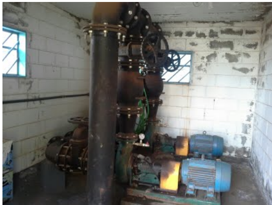
Descrição(3): Conjuntos de recalque
