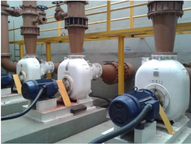
Bombas da Estação Elevatória de Esgoto.
