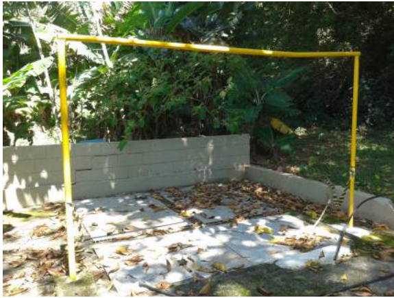
Elevatória de Esgoto da ETE Arboreto dos Jequitibás.
