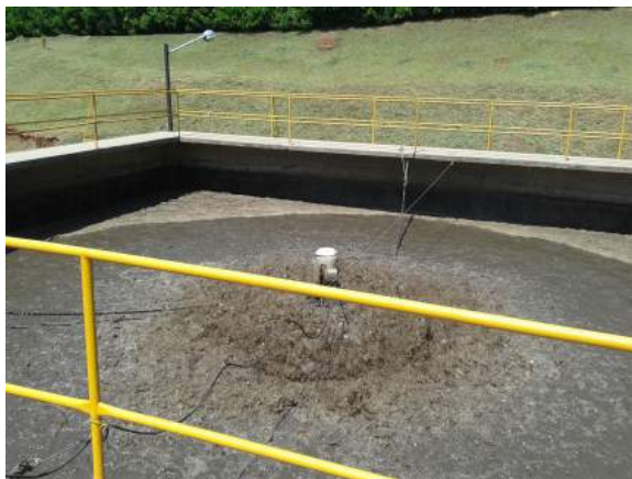
Tanque de Aeração em Funcionamento.
