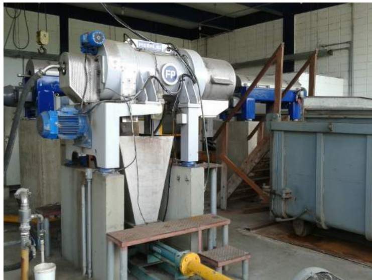
Centrífuga de Desidratação do Lodo.
