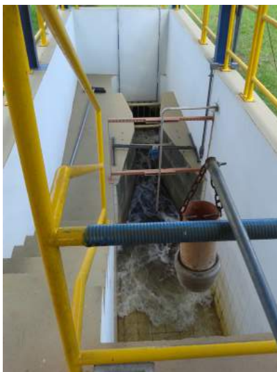
Saída do Efluente Final.
