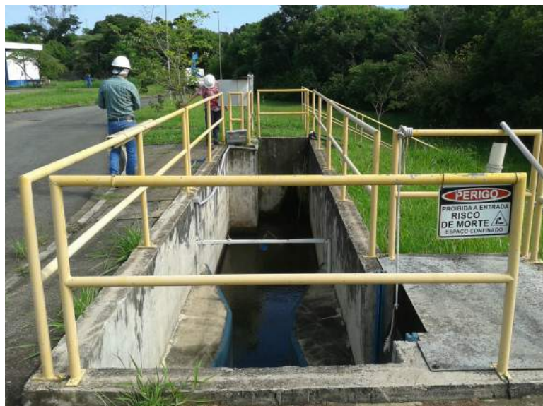
Saída do Efluente da ETE Samambaia.
