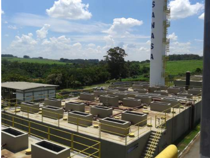
Reatores Anaeróbios de Tratamento de Esgoto.
