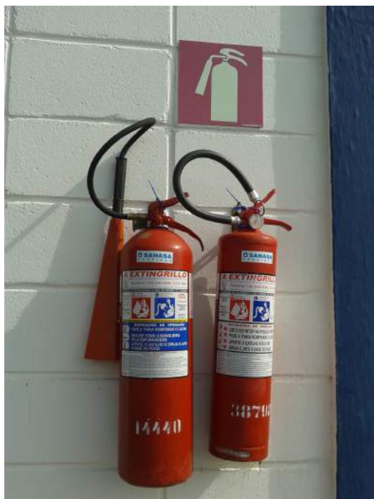
Extintores de Incêndio da ETE Samambaia.
