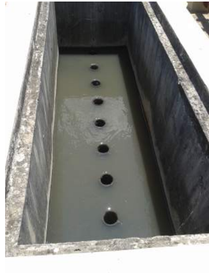
Detalhe da Entrada do Esgoto no Reator Anaeróbio.
