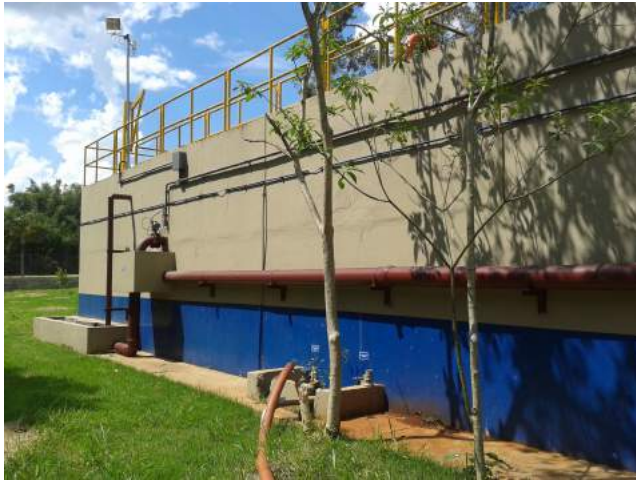
Vista Geral da ETE Terras do Barão.
