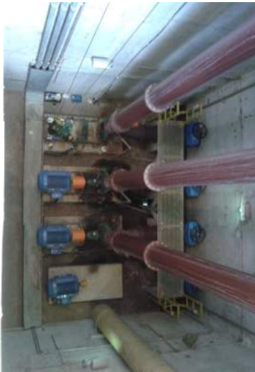
Bombas da Estação Elevatória de Esgoto.
