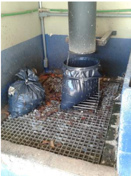
Deposição de Sólidos Grosseiros Removidos do Esgoto.
