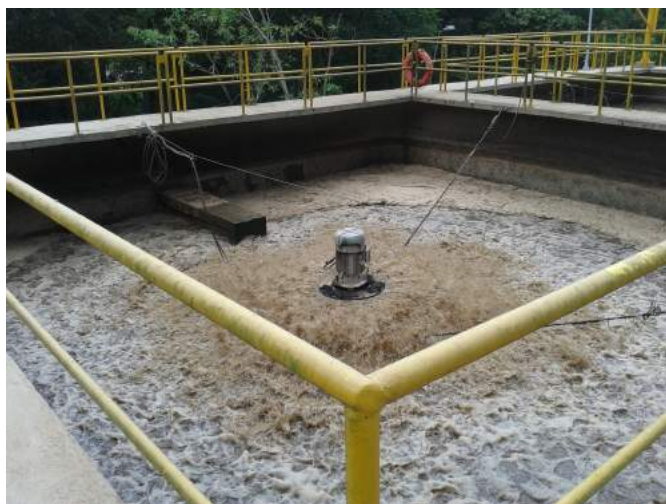
Tanque de Aeração em Funcionamento.
