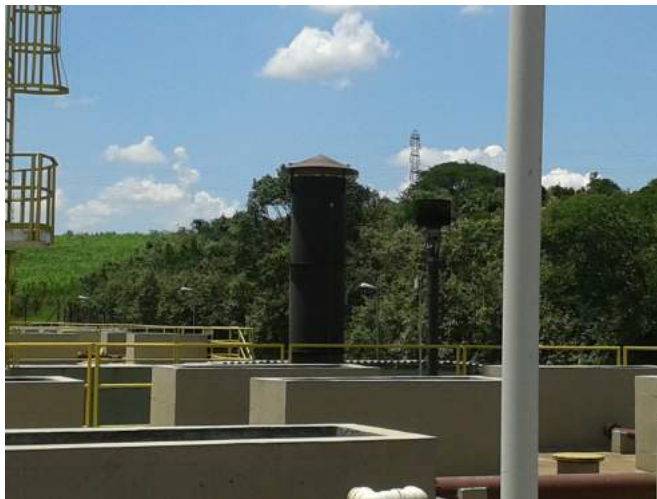
Queima de Gases no Flare.
