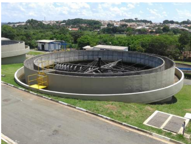
Filtro Biológico em Funcionamento.
