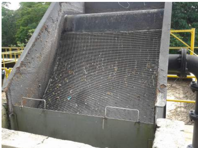
Grade de Remoção de Sólidos Grosseiros.
