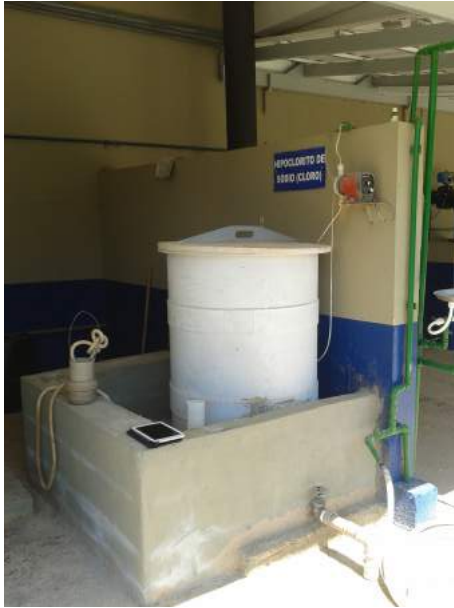
Tanque de Hipoclorito de Sódio para Desinfecção do Efluente.
