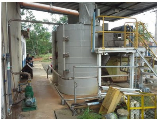
Descrição(8): Recalque do lodo, correção de pH e coagulante (Cloreto Ferrico) para desidratação por filtro prensa
