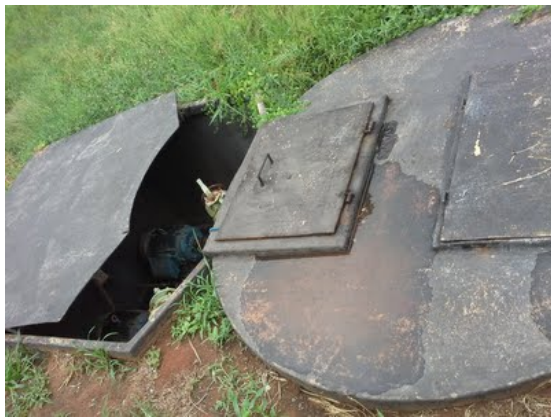
Descrição(10): Recalque do efluente final para emissário
