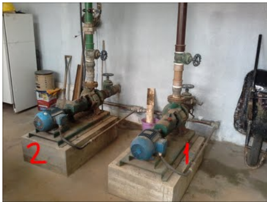
Descrição(7): Bombas de lodo (1) e efluente tratado (2)
