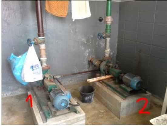
Descrição(6): Bombas de lodo (1) e efluente tratado (2)
