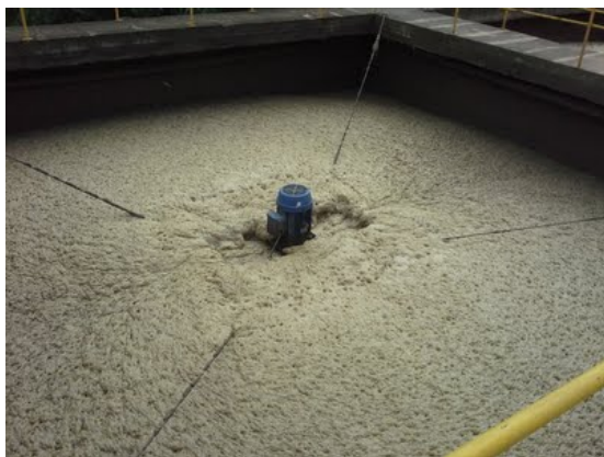
Descrição(5): Tanque em operação
