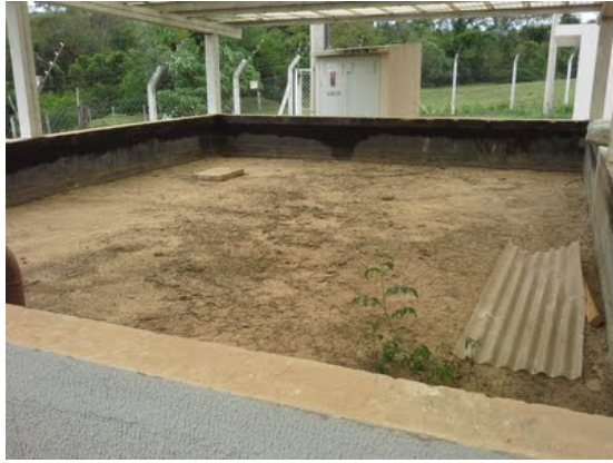
Descrição(9): Leito de secagem de lodo (nunca operou)
