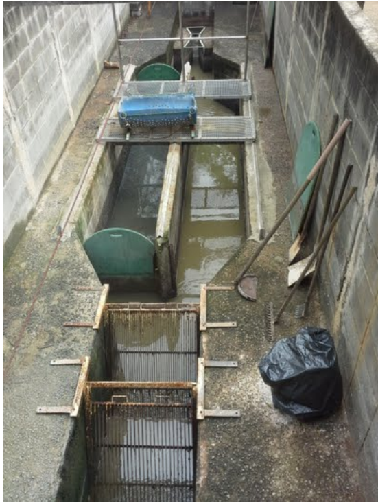
Descrição(1): Gradeamento grosseiro, desarenadores e medição de vazão
