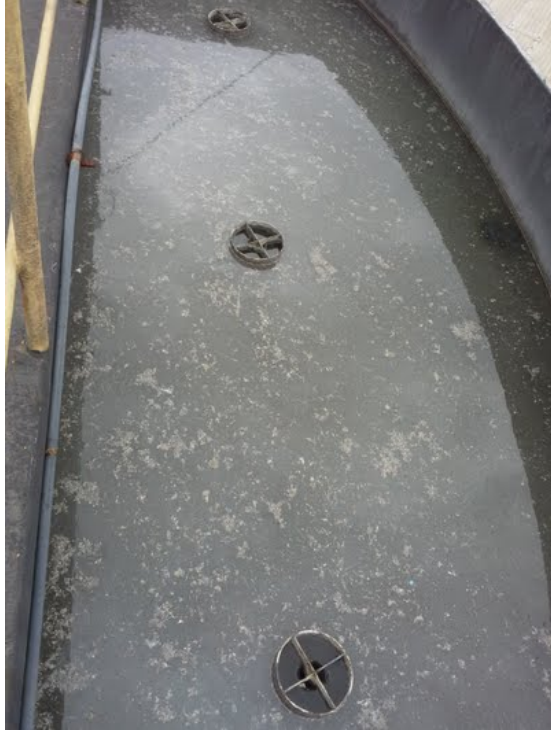
Descrição(5): Reator anaeróbio
