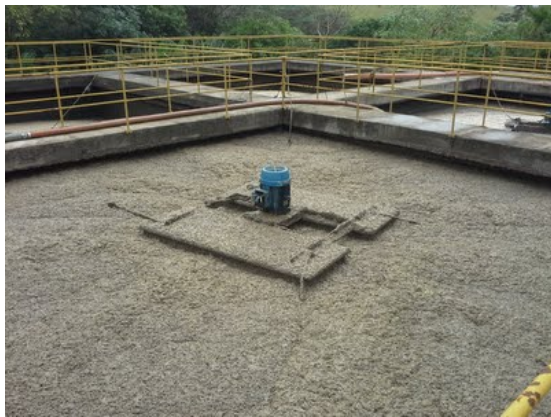
Descrição(4): Aspecto dos tanques de aeração com aeradores de superfície
