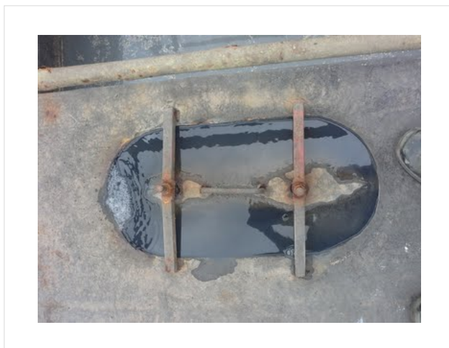
Descrição(8): Escape de gases da escotilha da caixa de distribuição
