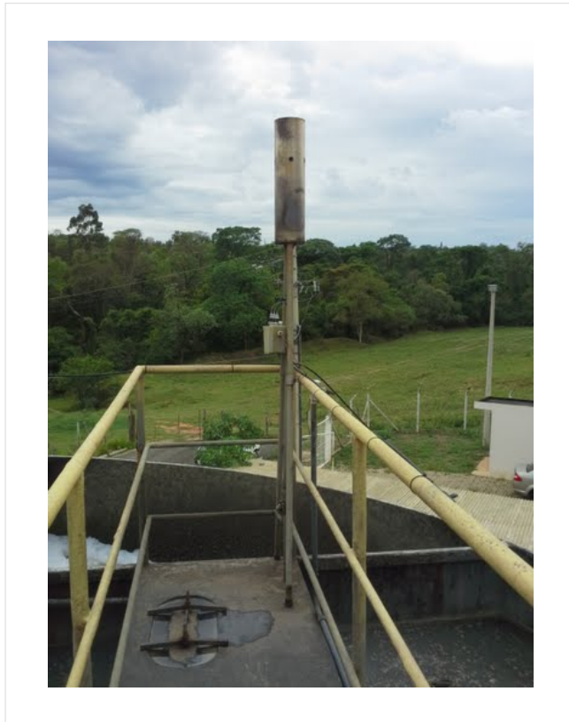
Descrição(7): Queimador de gases (quebrado na ocasião da visita)
