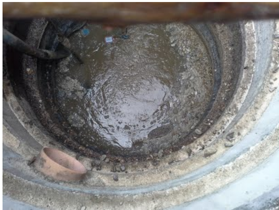
Descrição(2): Poço de sucção com bomba submersível
