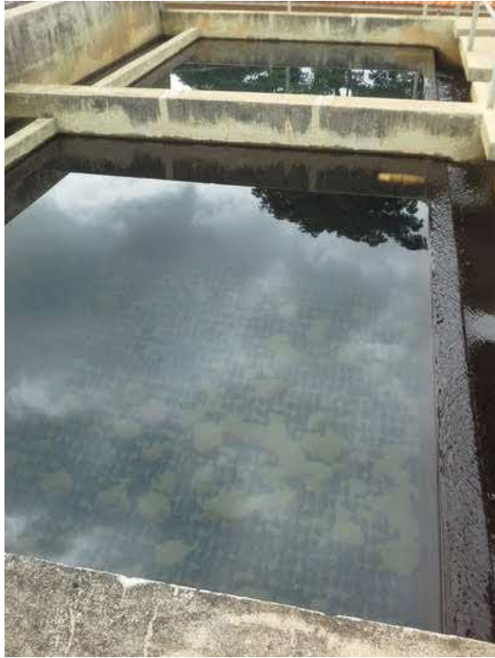
Descrição(7): Decantador (Módulo 1)
