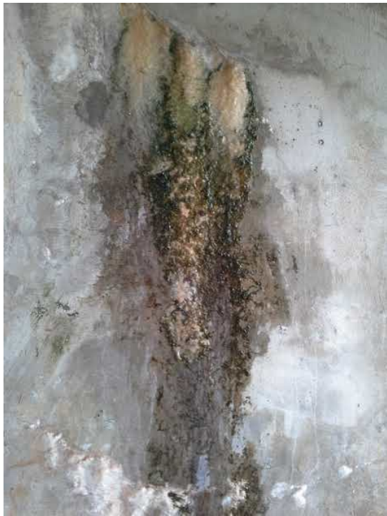
Descrição(11): Vazamentos nas Paredes dos Decantadores (Módulo 2)
