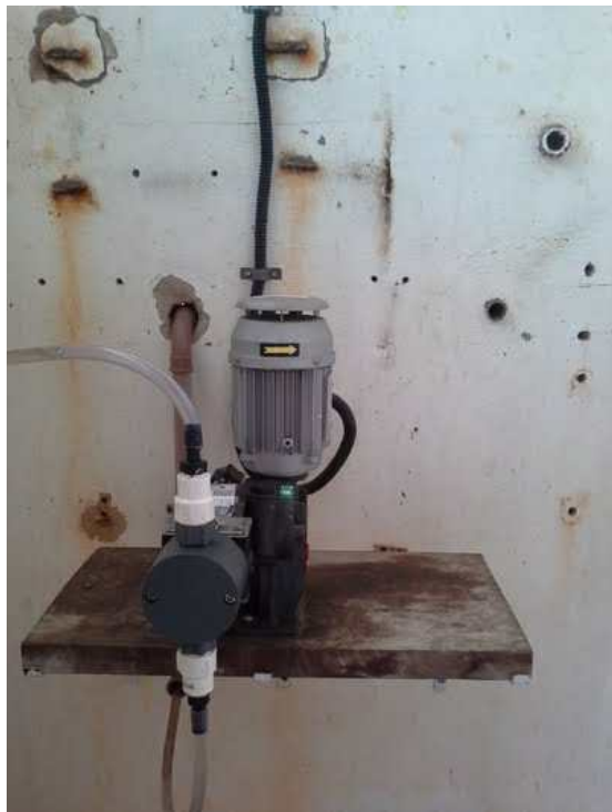
Descrição(14): Dosador de Cloro
