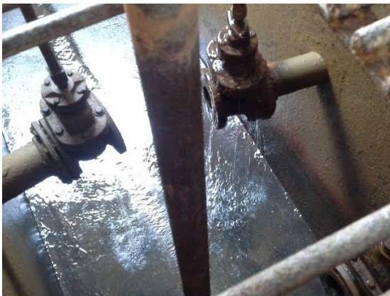
Descrição(10): Vazamento nos Registros - Módulo 1 e 2 (Descarga dos Decantadores)
