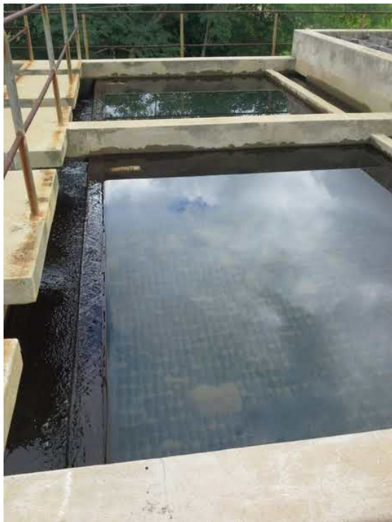
Descrição(6): Decantador (Módulo 2)
