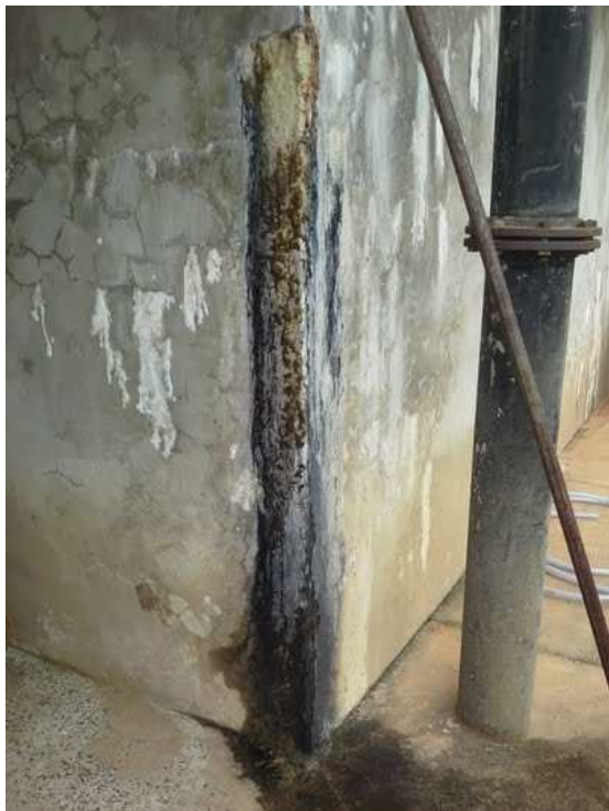
Descrição(12): Vazamento nas Paredes do Floculador (Módulo 2)
