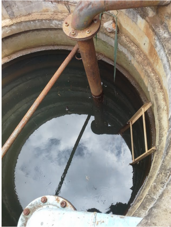
Descrição(2): Poço de Sucção
