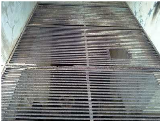
Descrição(18): Grades das Plataformas de Acesso Inadequadas
