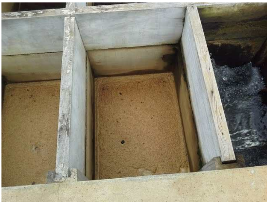
Descrição(4): Formação de Flocos (Flocculador 2)
