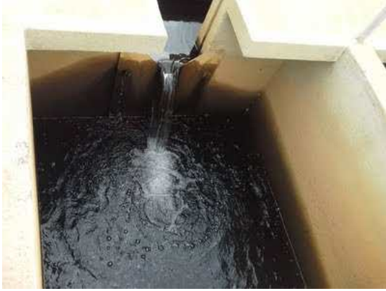
Descrição(9): Filtração (Módulo 1)
