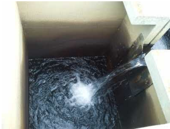
Descrição(8): Filtração (Módulo 2)
