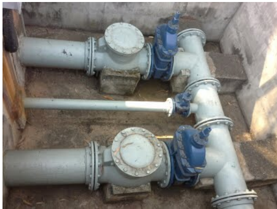
Descrição(4): Barrilete de recalque
