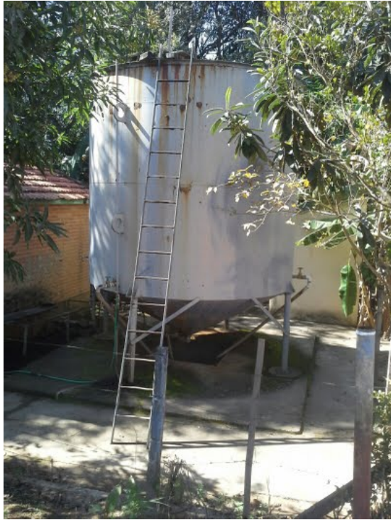
Descrição(3): Aspecto geral do decantador
