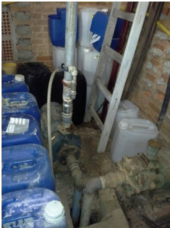
Descrição(6): Conjunto de recalque para reservatório
