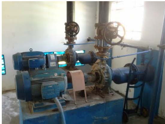
Descrição(3): Conjuntos de recalque
