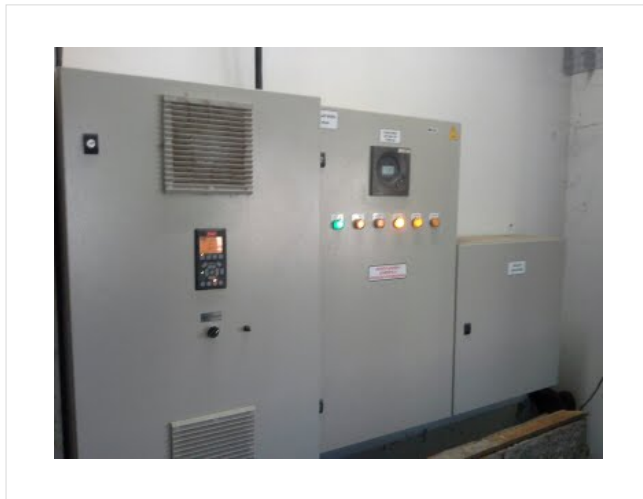
Descrição(7): Painéis elétricos
