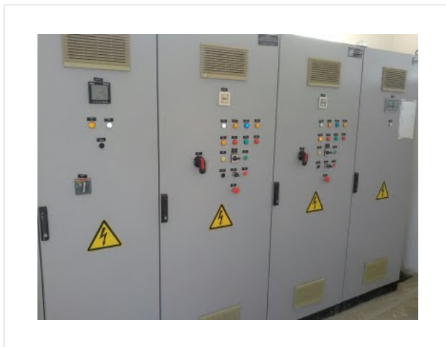
Descrição(5): Painéis elétricos
