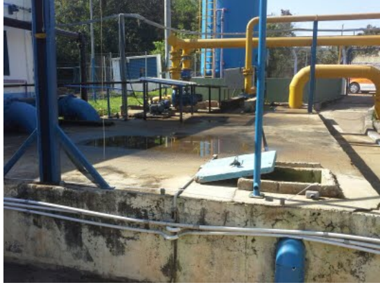
Descrição(12): Tanque de contato e sucção da EEAT
