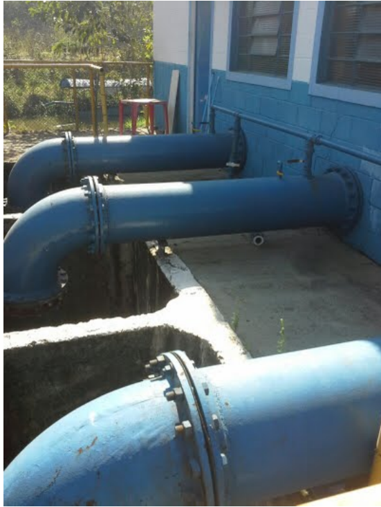
Descrição(4): Sucção das bombas aspiradas
