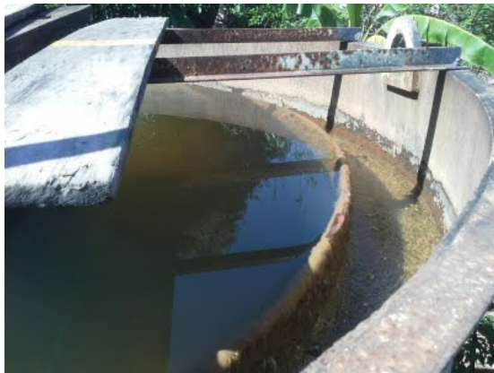
Descrição(2): Saída do decantador
