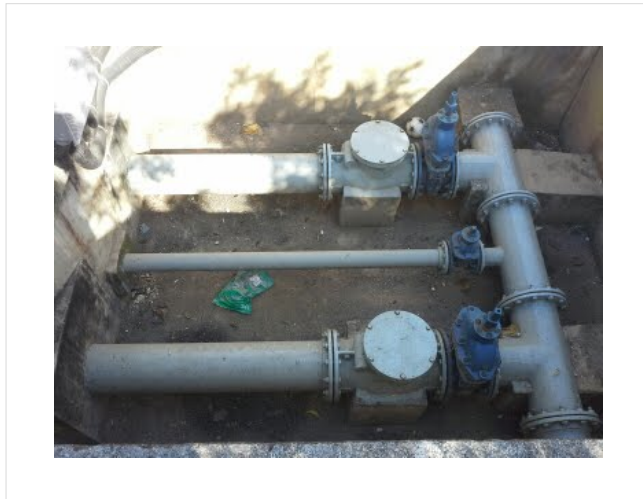
Descrição(3): Barrilete de recalque
