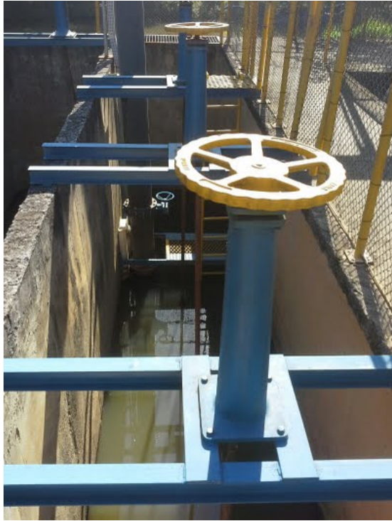
Descrição(2): Comportas e poço de sucção de bomba submersível
