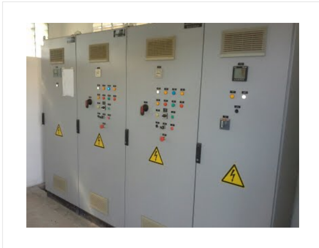
Descrição(5): Painéis elétricos
