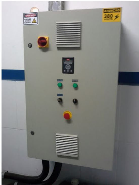
Descrição(2): Painel elétrico
