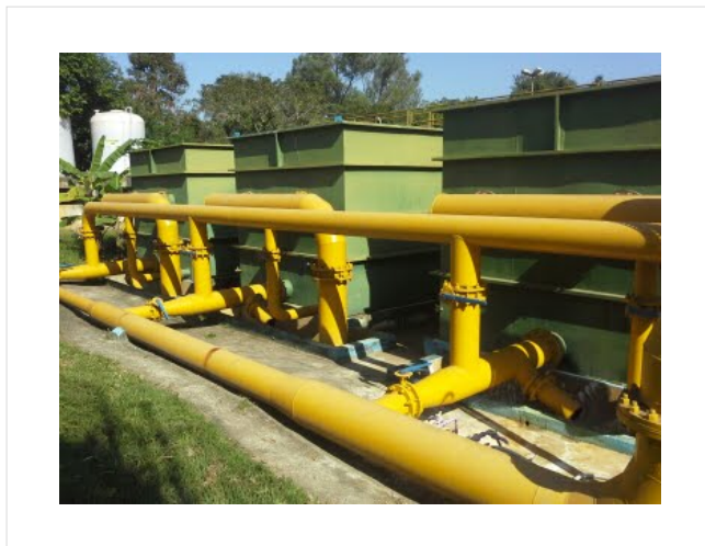
Descrição(7): Tubulações de saída dos filtros
