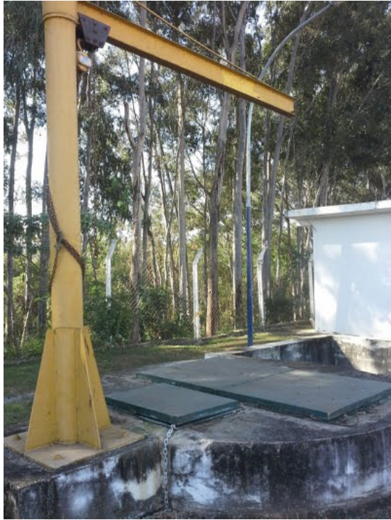
Descrição(3): Poço de sucção
