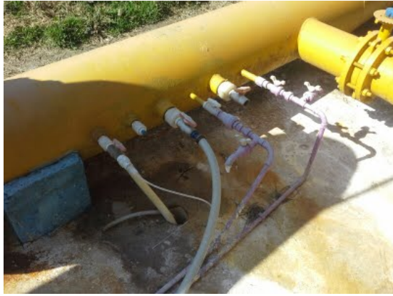
Descrição(8): Ponto de aplicação de Cloro, Flúor e correção de pH
