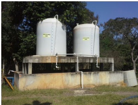
Descrição(13): Armazenamento de coagulante
