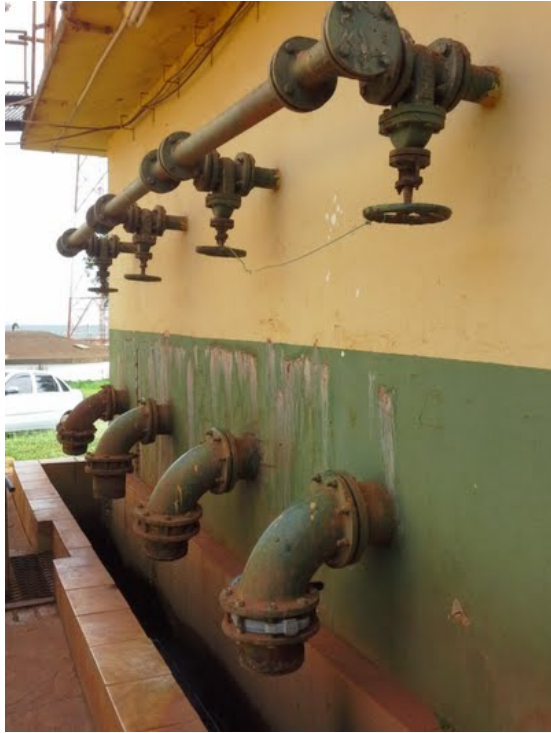
Descrição(4): Saída dos filtros
