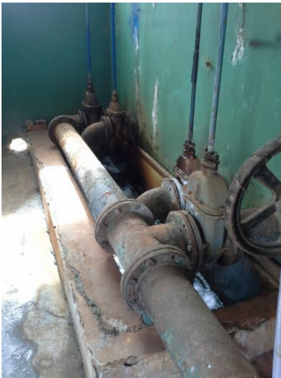
Descrição(6): Saída dos filtros
