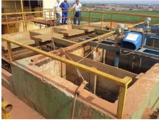
Descrição(2): Floculadores, decantadores e filtros da ETA 2
