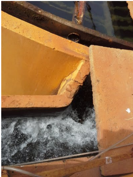
Descrição(3): Saída da água decantada
