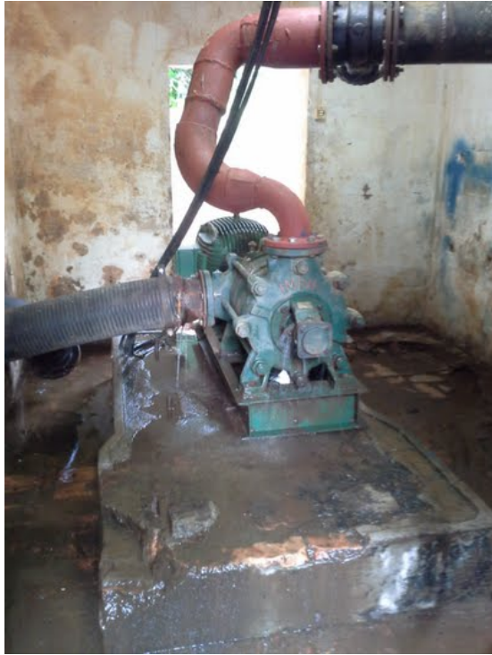
Descrição(4): Conjunto de recalque
