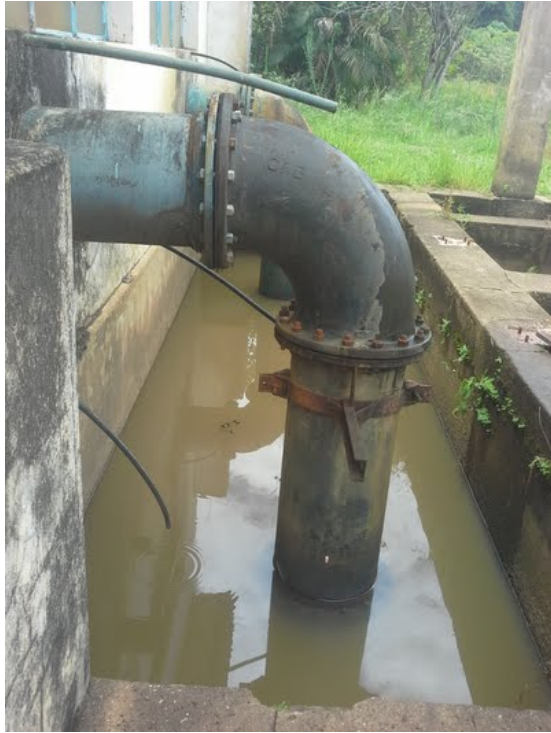
Descrição(2): Poço de sucção
