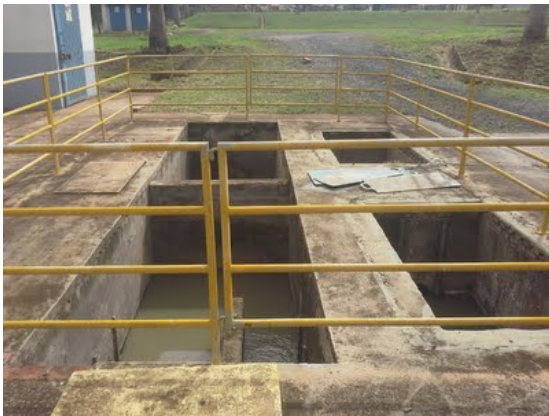
Descrição(7): Caixa de areia
