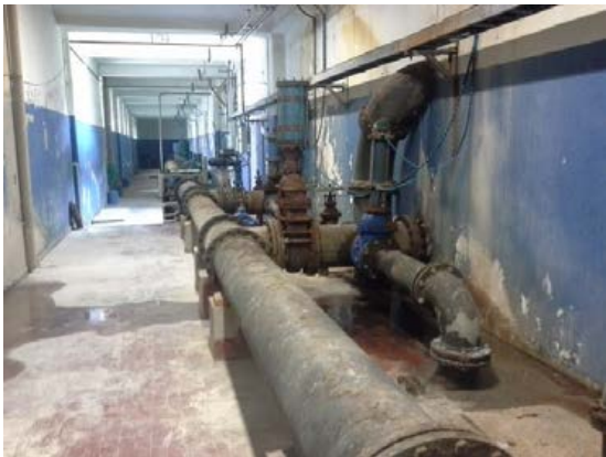
Descrição(11): Tubulação de saída dos filtros
