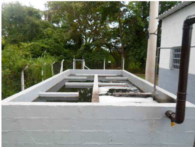
Descrição(3): Tanque de desinfecção
