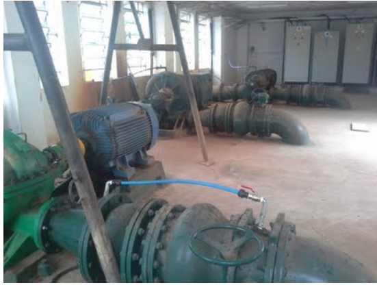
Descrição(4): Conjuntos de recalque
