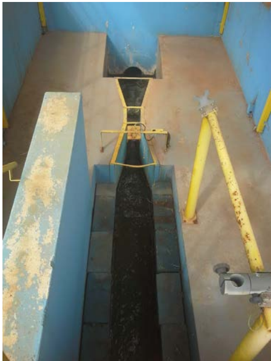
Descrição(4): Saída esgoto tratado
