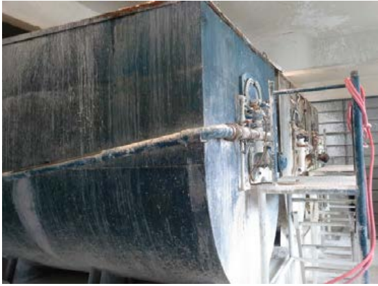
Descrição(9): Sistema de dosagem de cal
