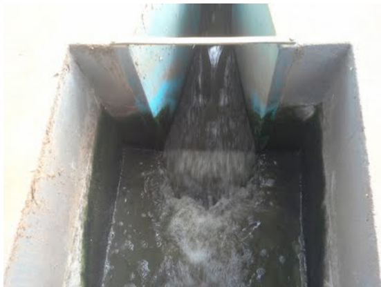
Descrição(5): Detalhe saída do esgoto tratado
