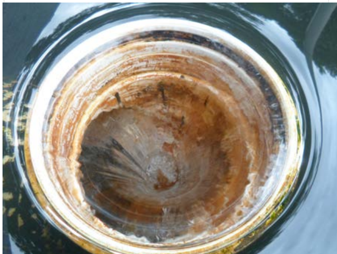
Descrição(4): Saída Esgoto tratado
