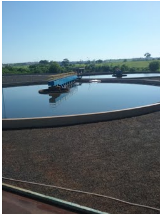
Descrição(12): Decantadores secundários
