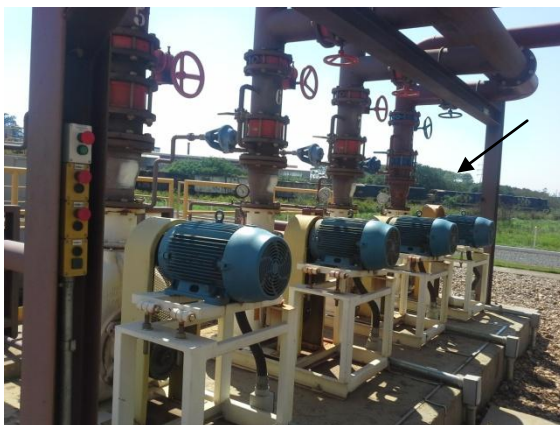
Figura 4: À direita conjunto de recalque novo
