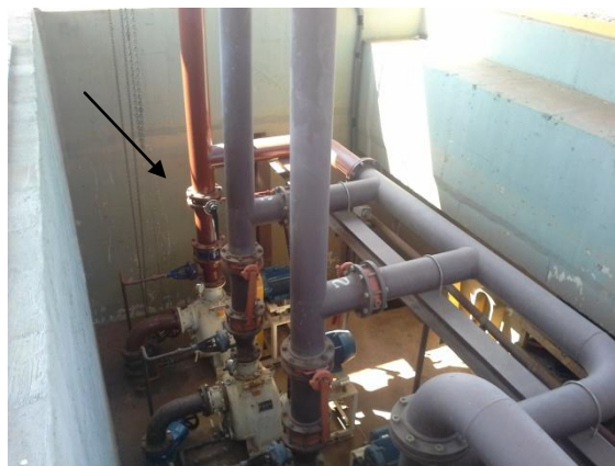
Figura 5: À esquerda conjunto de recalque novo
