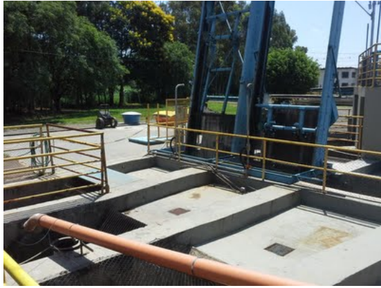
Descrição(1): Gradeamento grosseiro com limpeza mecânica e manual
