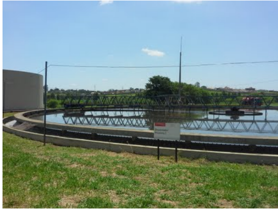
Descrição(8): Decantador primário
