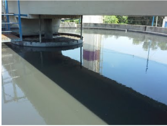
Descrição(5): Adensador de lodo
