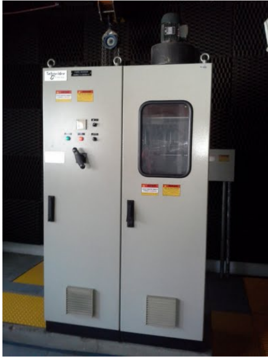
Descrição(4): Inversor de frequência dos conjuntos 7 e 8
