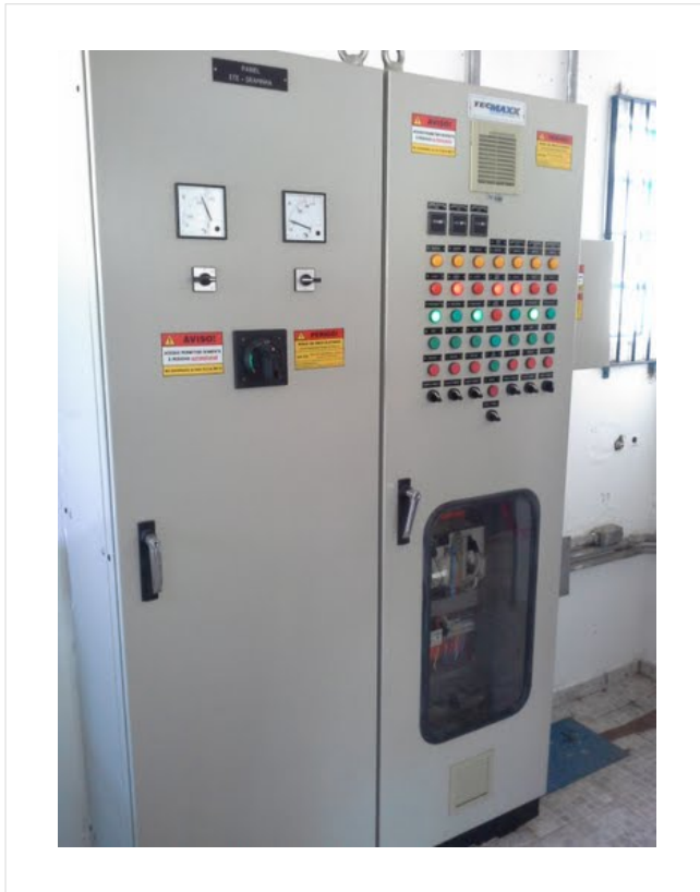
Descrição(4): Painéis elétricos
