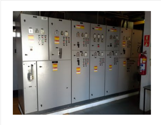
Descrição(2): Painéis elétricos
