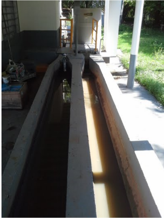
Descrição(2): Desarenadores e Calha Parshall
