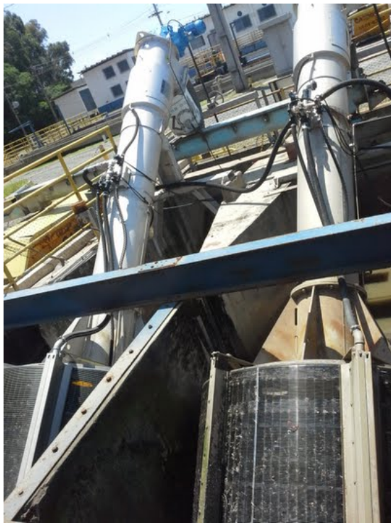
Descrição(2): Gradeamento fino
