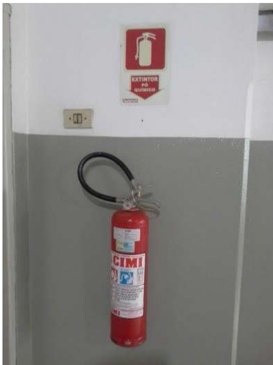
Descrição(4): Extintor de Incêndio - Poço 1 e 2
