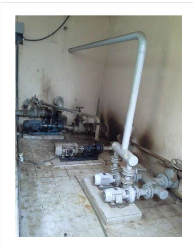
Descrição(11): Conjuntos moto-bomba da EEAT - Portal dos Nobres
