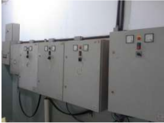
Descrição(3): Painele Elétrico - Poço 1, 2 e 3
