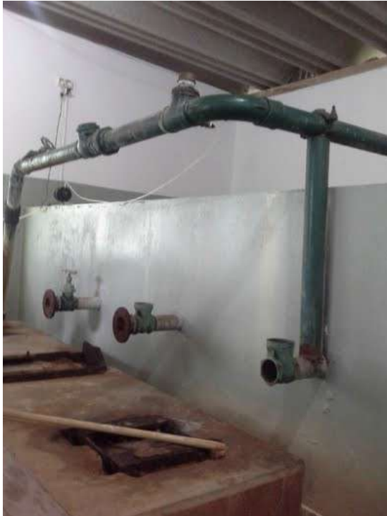
Descrição(5): Dosador de Cloro
