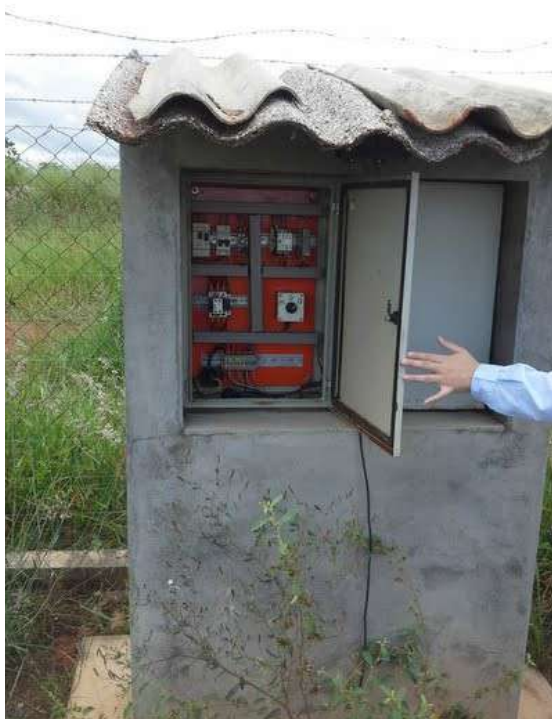
Descrição(3): Painel Elétrico - EEEB Jardim dos Ipês
