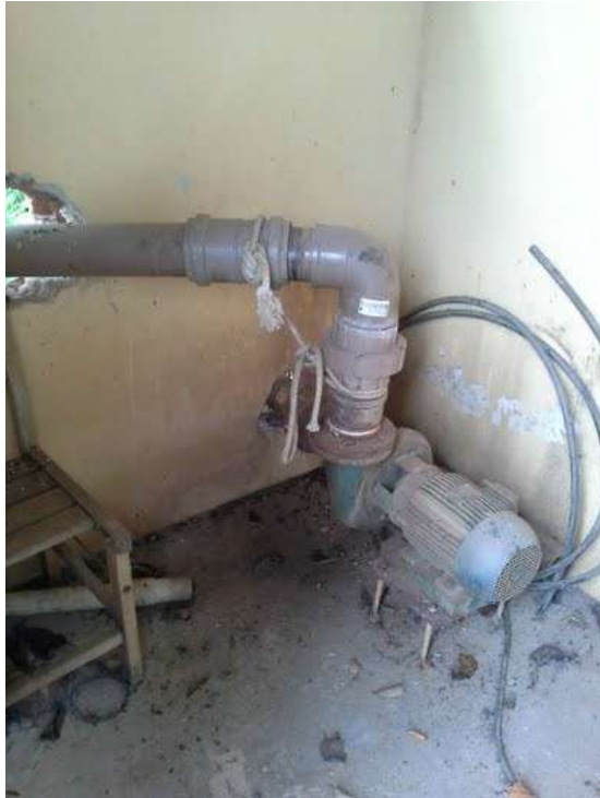
Descrição(6): Conjunto moto-bomba da Elevatória de Captação de Água Superficial - Portal dos Nobres.
