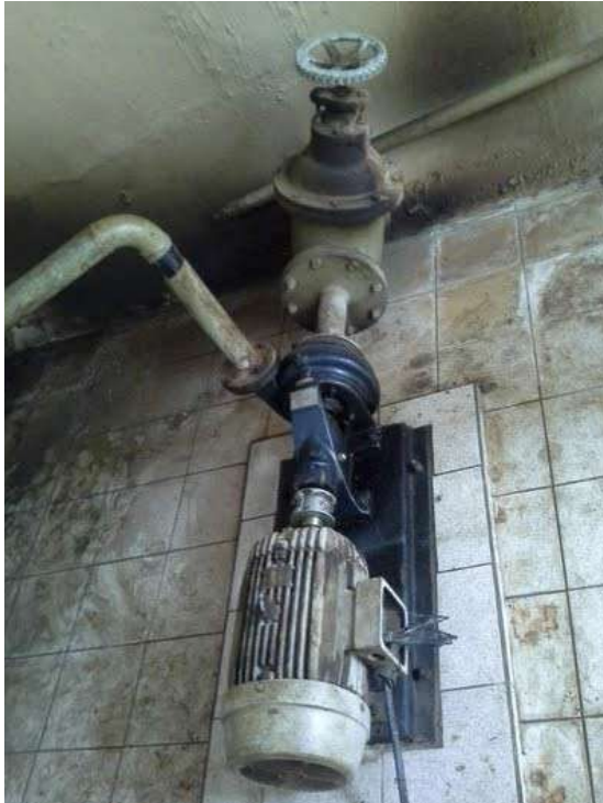
Descrição(12): Conjunto moto-bomba reserva da EEAT instalada - Portal dos Nobres
