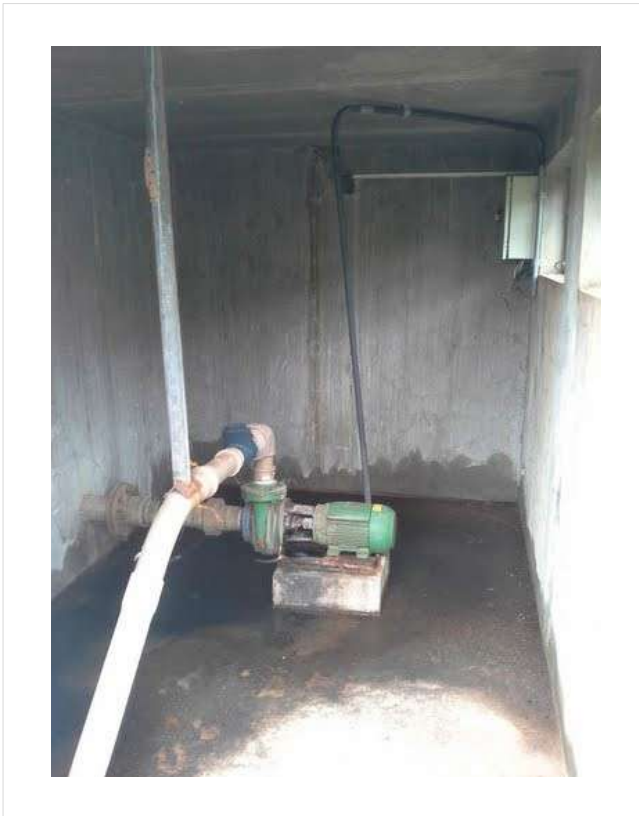
Descrição(1): Conjunto moto-bomba - EEEB Centro
