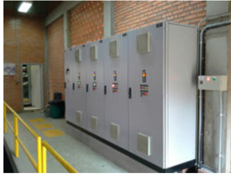
Descrição(8): Vista geral dos Painéis Elétricos de Comando dos conjuntos motobombas Imagem(9)
