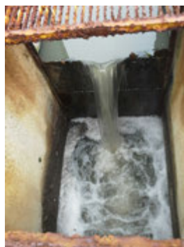
Descrição(14): Detalhe de um dos vertedores de saída do efluente tratado da lagoa facultativa
