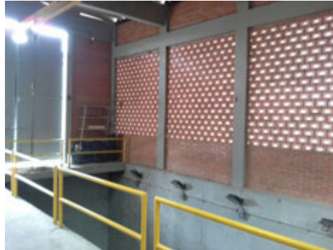
Descrição(9): Detalhes da ventilação natural e do guarda corpo da plataforma do mezanino Imagem(10)
