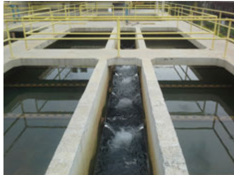
Descrição(15): Módulos de decantadores com guarda - corpos nas passarelas de operações
