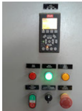
Descrição(10): Detalhe dos botões de comando elétrico das operações das bombas Imagem(11)
