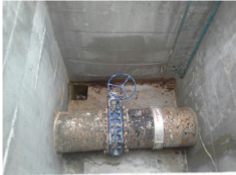
Descrição(5): Caixa de inspeção com tubulação de interligação de dois Reservatórios Semienterrados
