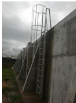
Descrição(6): Escada metálica com guarda-corpos para acesso à cobertura de um dos Reservatórios Semienterrados
