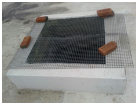
Descrição(7): Caixa de inspeção na cobertura de um dos Reservatórios Semienterrados com uma tela improvisada
