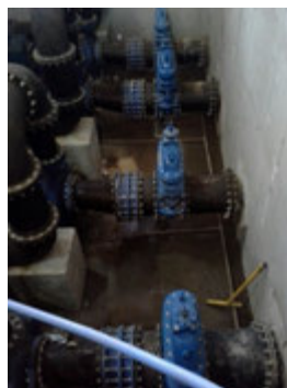
Descrição(11): Barrilete da tubulação de sucção afogada com registros
