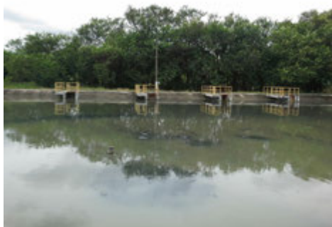
Descrição(10): Vertedores de saída do esgoto tratado pelas lagoas de aeração seguida da lagoa facultativa
