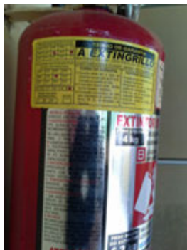
Descrição(18): Extintor de incêndio no laboratório
