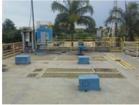
Descrição(14): Floculadores cobertos com agitadores mecanizados
