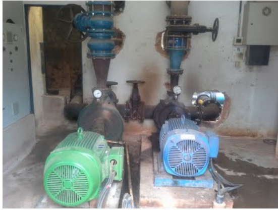
Descrição(2): Conjuntos de recalque
