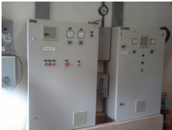
Descrição(3): Painel das bombas
