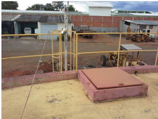
Descrição(4): Tampa inspeção
