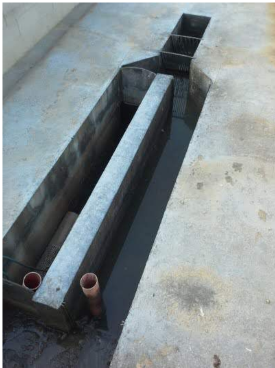
Descrição(3): Vista geral do tratamento preliminar da elevatória
