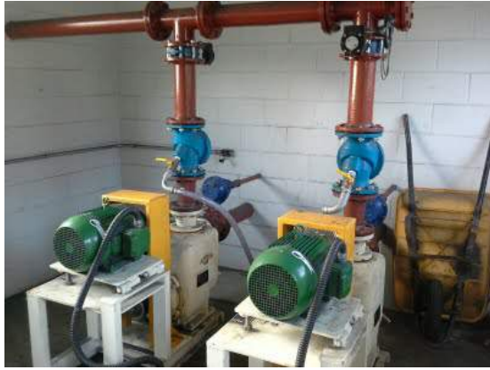
Descrição(2): Vista geral do conjunto moto-bomba instalada e reserva da elevatória
