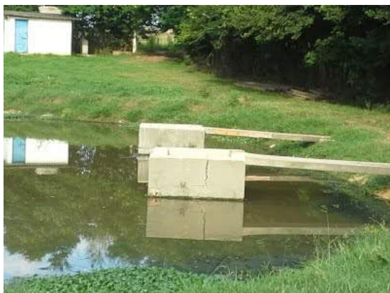
Descrição(4): Ausência de guarda-corpo na passarela de acesso da lagoa anaeróbia da estação
