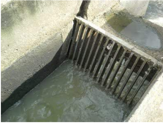
Descrição(2): Vista detalhada do gradeamento grosseiro da estação
