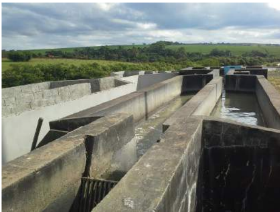
Descrição(3): Vista geral do tratamento preliminar da estação
