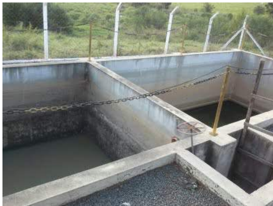
Descrição(5): Vista geral do tanque pulmão
