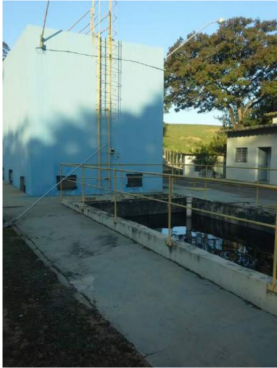
Descrição(4): Vista geral do filtro biológico aerado
