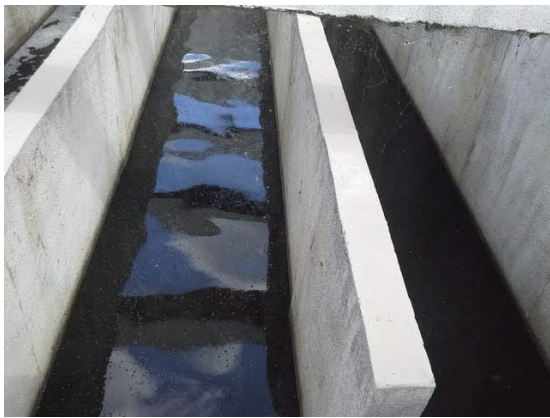
Descrição(11): Tanque de contato de hipoclorito
