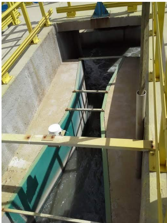
Calha Parshall e macromedidor
