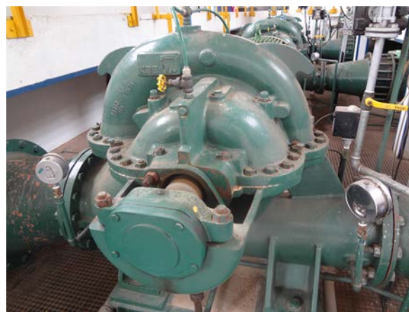
Detalhe do conjunto moto bomba
