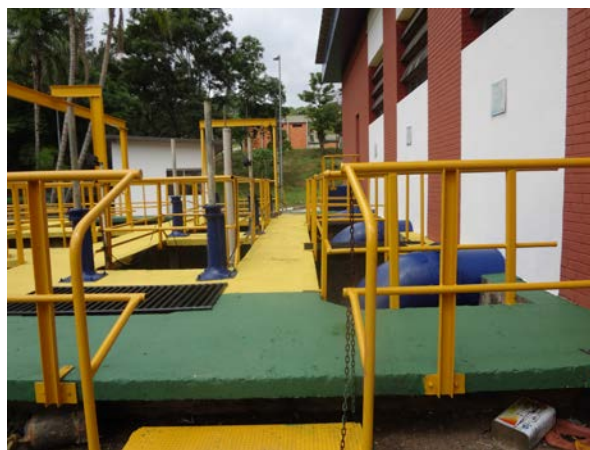
Poço de sucção
