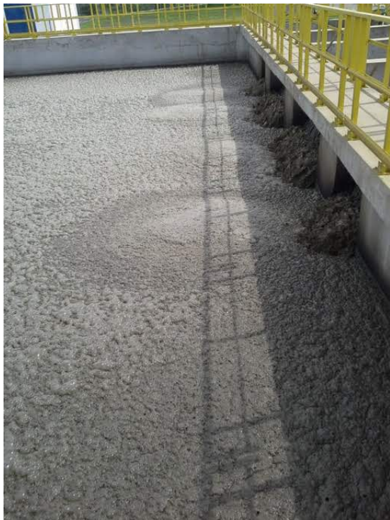
Descrição(8): Reator biológico com MBR
