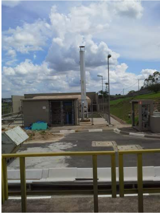
Descrição(5): Queimador flare
