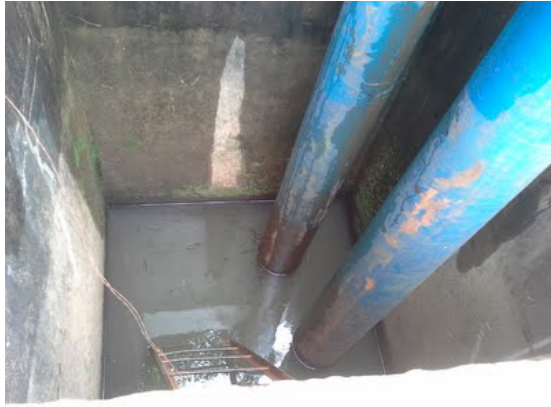
Descrição(2): Poço Sucção
