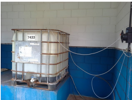
Descrição(6): Sistema de dosagem de flúor
