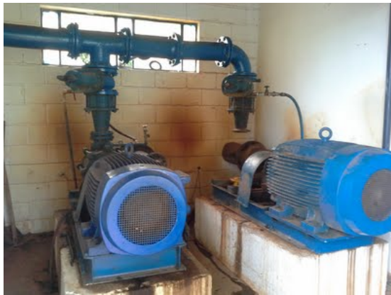
Descrição(6): Conjunto de recalque
