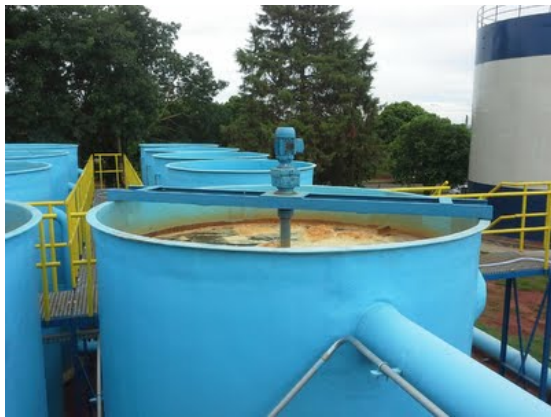
Descrição(2): Detalhe floculador
