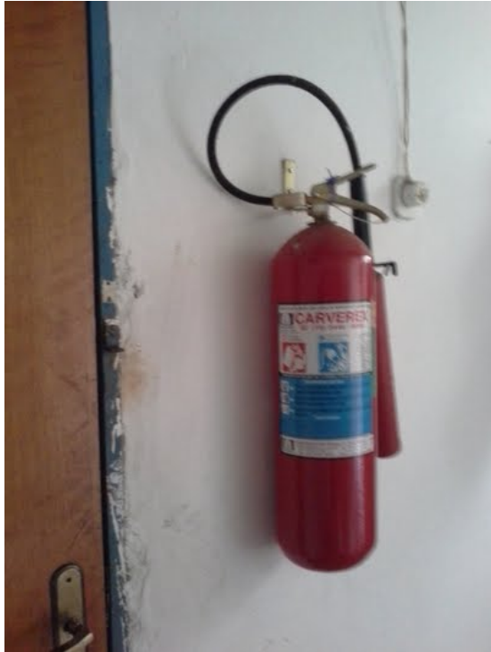
Descrição(5): Extintor de incêndio
