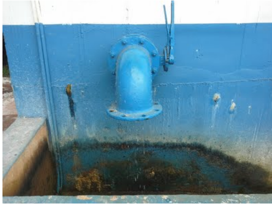
Descrição(7): Detalhe vazamento saída filtro
