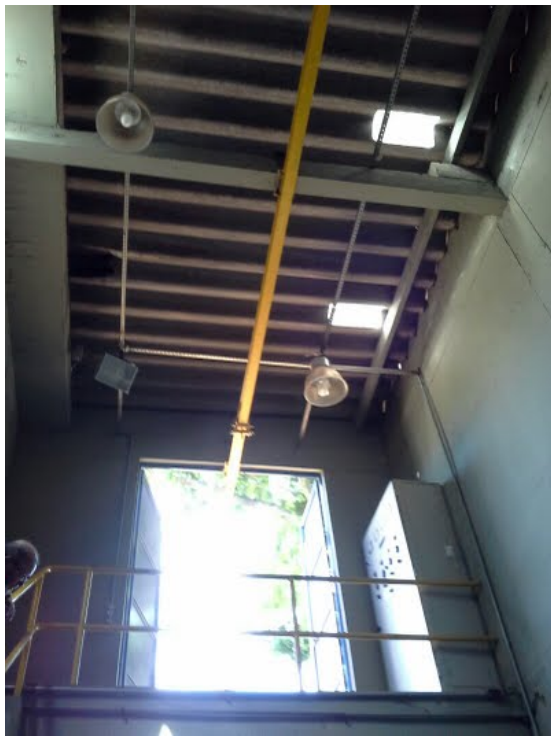
Descrição(6): Iluminação e monovia
