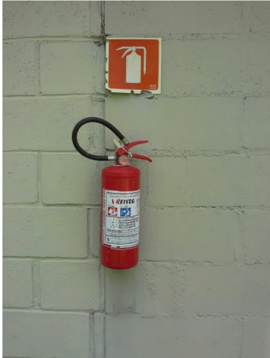
Descrição(3): Extintor de incêndio
