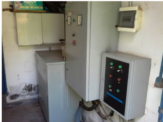
Descrição(6): Painel elétrico e transformador
