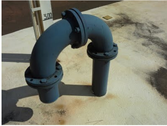
Descrição(3): Tubulação de ventilação
