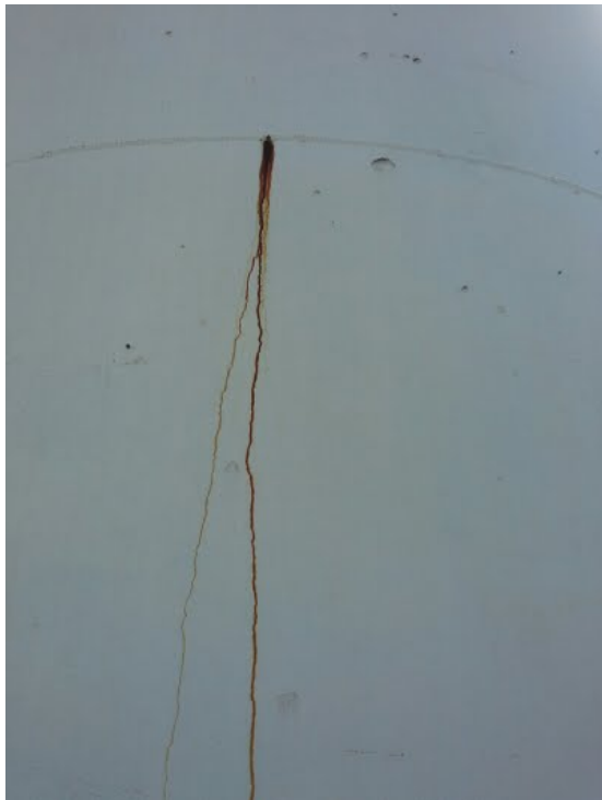
Descrição(3): Pontos de corrosão acelerada
