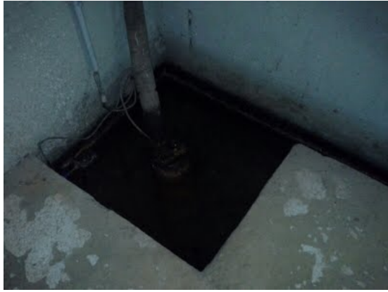
Descrição(5): Drenagem da EEAT
