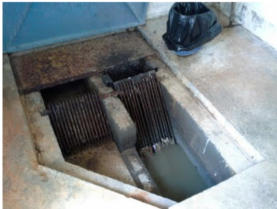
Descrição(4): Gradeamento grosseiro
