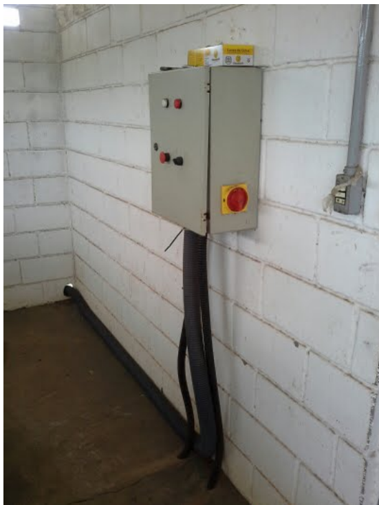
Descrição(3): Painel elétrico
