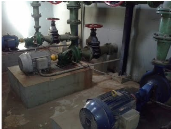
Descrição(4): Conjuntos de recalque
