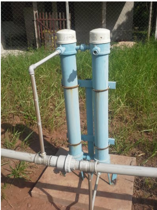
Descrição(2): Sistema de dosagem de cloro e flúor
