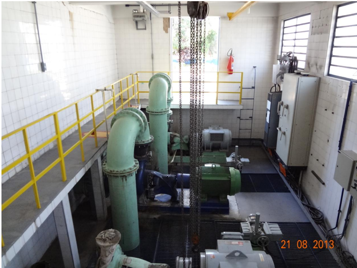
Figura 7 – Estação Elevatória junto a ETA 1
