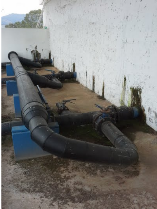
Descrição(2): Saída dos filtros
