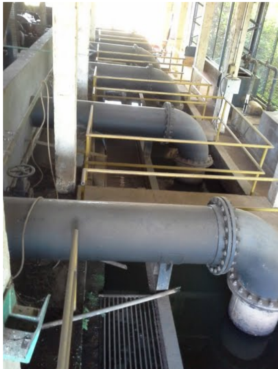
Descrição(3): Poços de sucção
