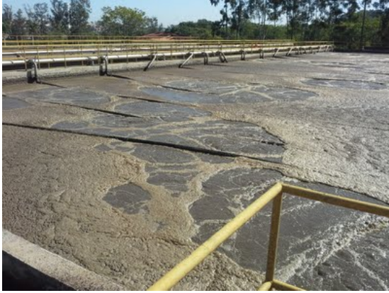
Descrição(5): Tanques de aeração
