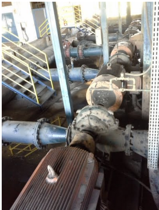
Descrição(2): Conjuntos de recalque
