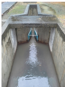
Descrição(6): Desarenador de câmara única e na sequencia uma calha parshal.
