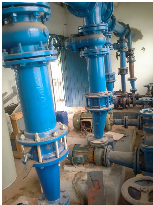
Descrição(5): Outra vista dos conjuntos moto-bombas e barriletes.
