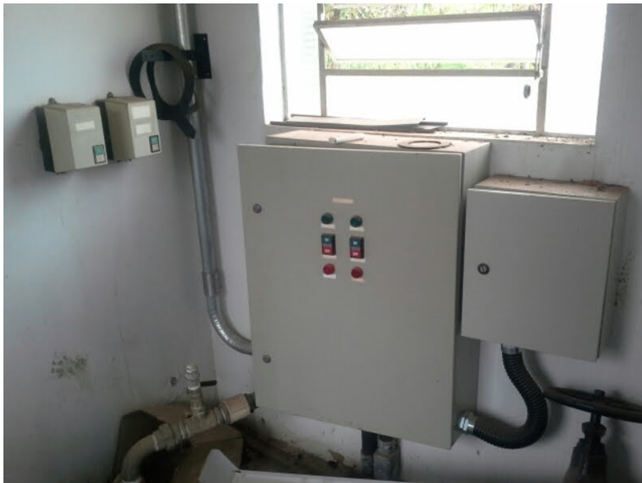
Descrição(3): Painéis de comando elétrico dos conjuntos moto-bombas.
