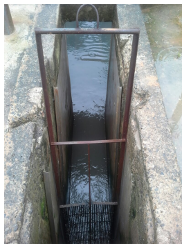
Descrição(5): Gradeamento na entrada do esgoto bruto.
