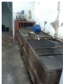
Descrição(6): Tanques com as misturas de PAC e bombas dosadoras de aplicação nos processos de floculação das ETAs 1 e 2 compactas.
