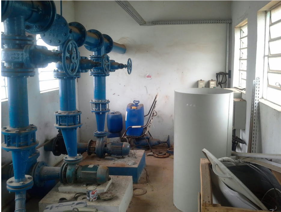
Descrição(2): Vista de dois barriletes de tubulações de recalque de água, independentes e alimentados por Reservatórios de água tratada.
