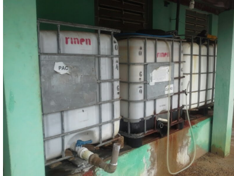
Descrição(4): Estocagem de hipoclorito de sódio e PAC.
