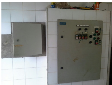
Descrição(5): Painéis elétricos de comandos dos conjuntos moto-bombas
