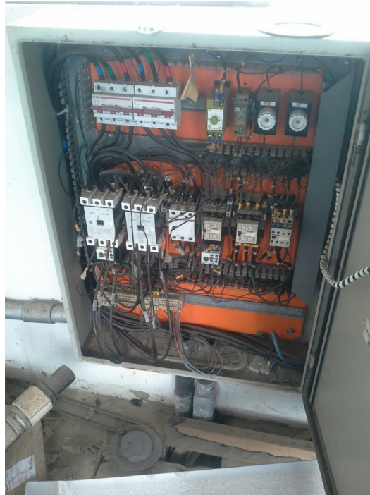
Descrição(4): Detalhe do painel elétrico maior.
