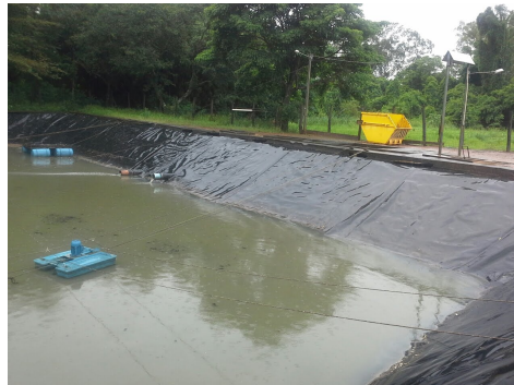
Descrição(4): Detalhe da entrada do esgoto bruto na lagoa aeróbia, o qual, já passou pelo tratamento preliminar de gradeamento e desarenação.
