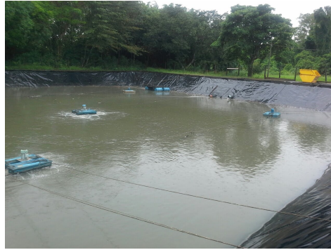
Descrição(3): Detalhes dos areadores de superfície em funcionamento.
