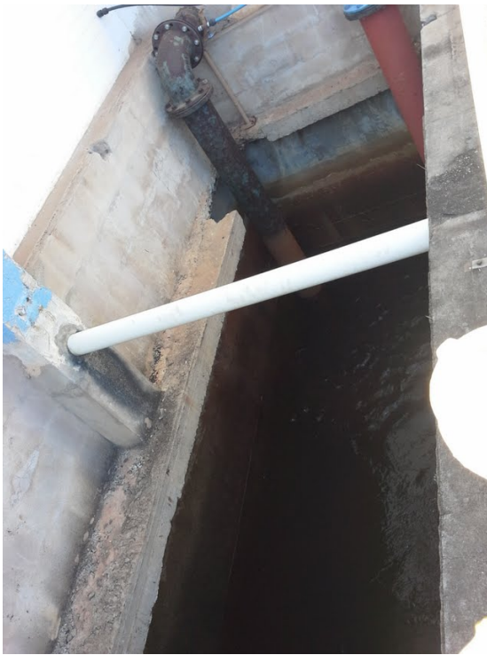
Descrição(4): Poço de sucção aberto
