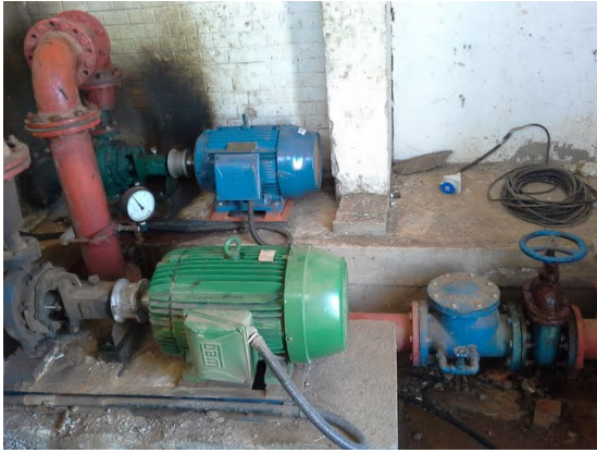
Descrição(3): Instalações internas (conjuntos de recalque)
