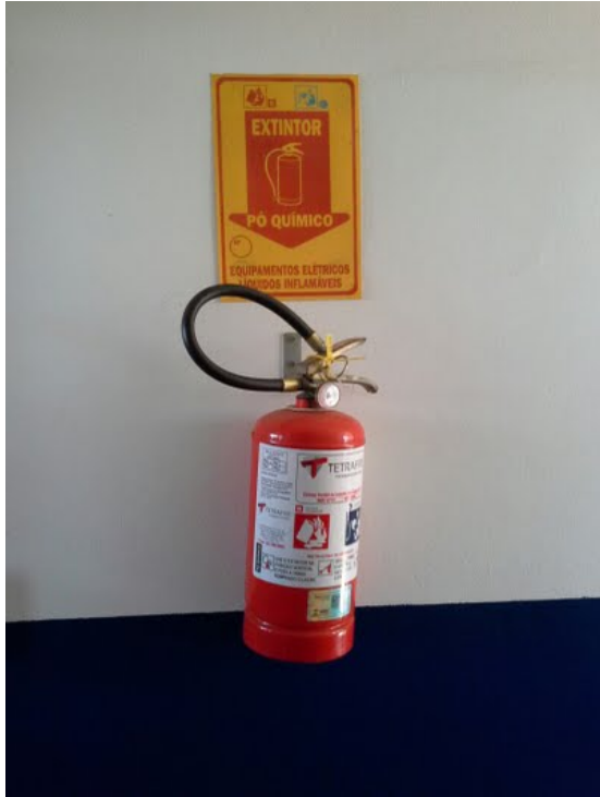
Descrição(3): Extintor de incêndio
