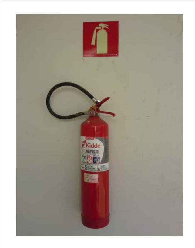
Descrição(3): Extintor de incêndio na área dos sopradores, ausente quando da inspeção de Diagnóstico
