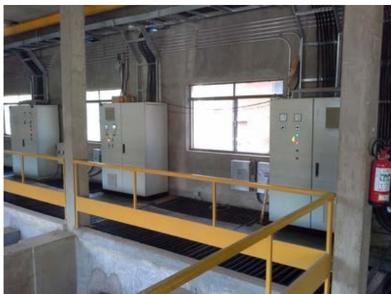
Descrição(4): Painéis elétricos
