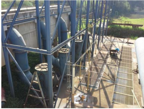
Descrição(2): Recalque para desarenadores
