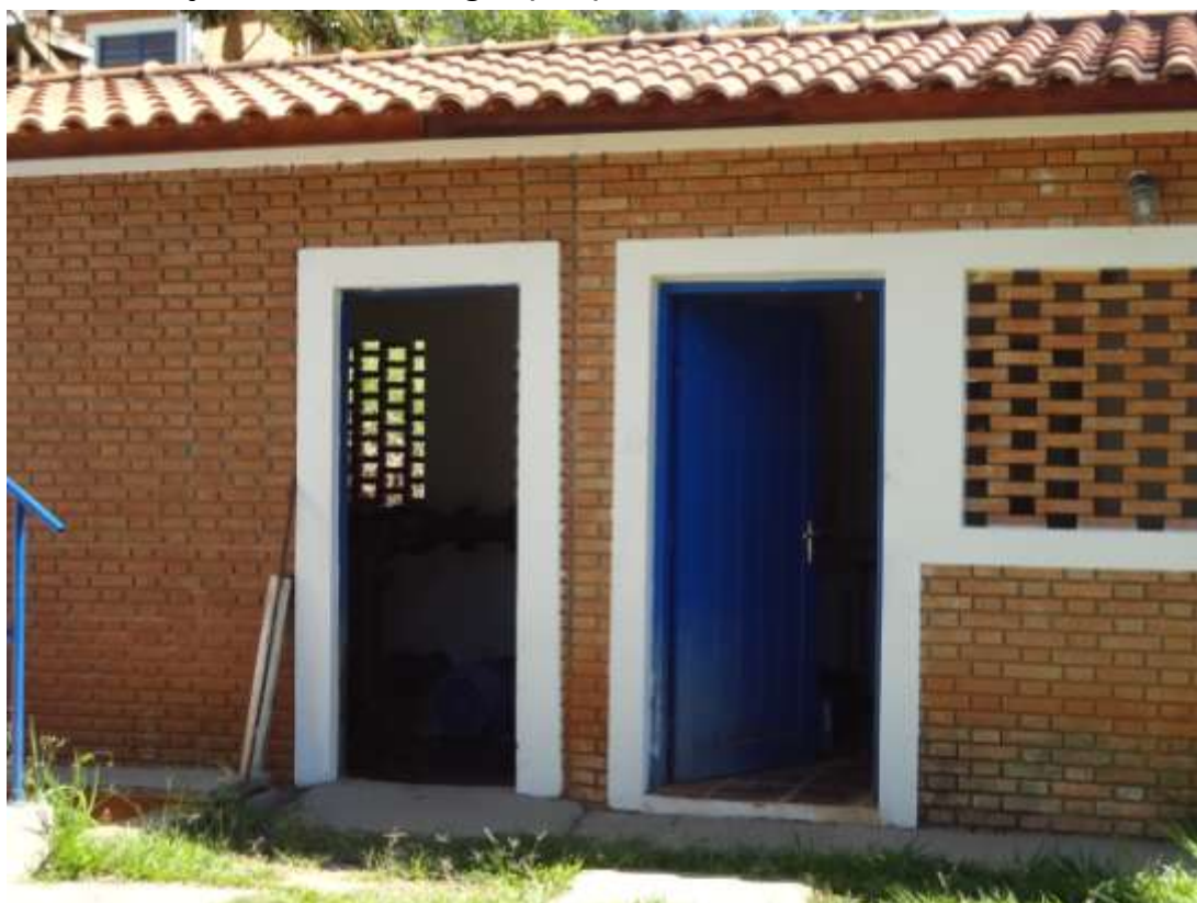
Figura 5 – Estação Elevatória junto a ETA
