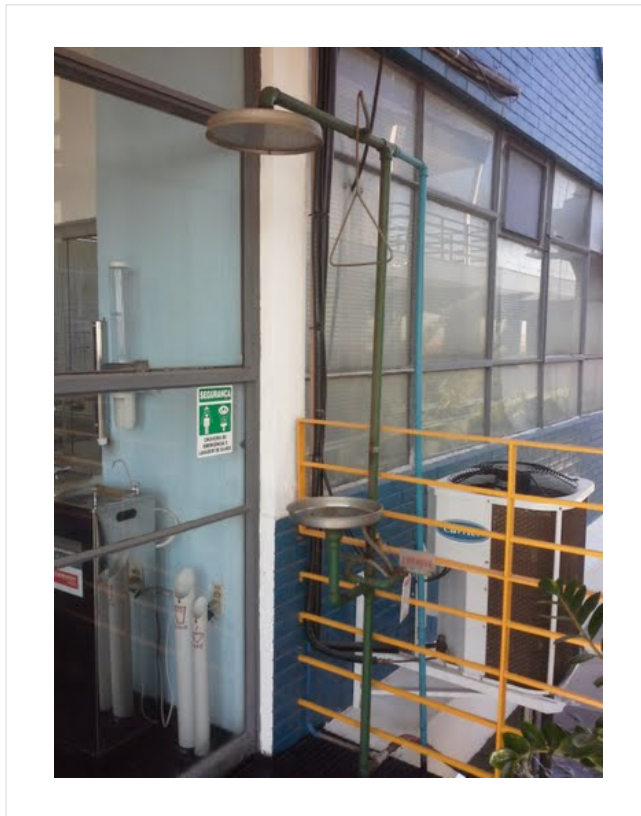
Descrição(4): Chuveiro de emergência
