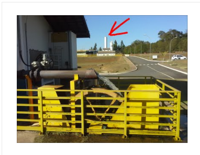
Descrição(8): Roda d'água para recalque de parte do efluente final para reservatório de água de reúso (ao fundo)
