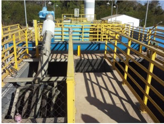
Descrição(3): Gradeamento fino, desarenadores e removedor de gordura
