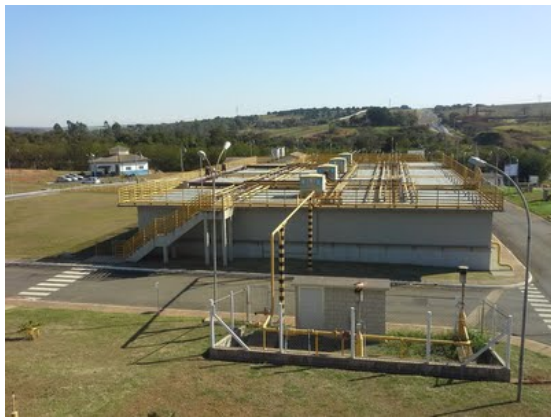
Descrição(4): Queimador de gases e UASB
