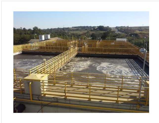
Descrição(6): Tanques de aeração
