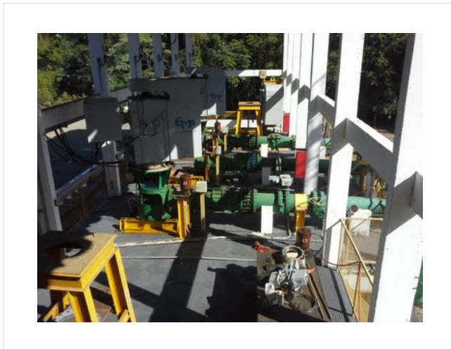
Descrição(4): Conjuntos de recalque
