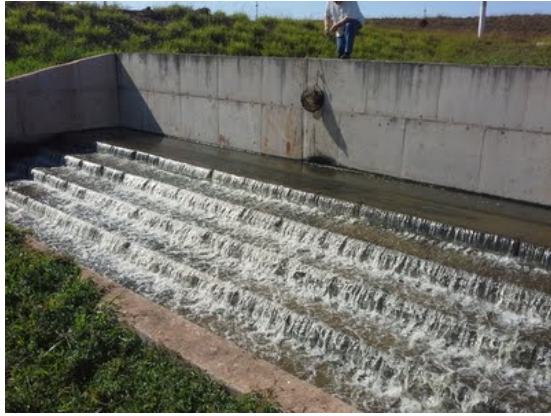
Descrição(4): Desinfecção com pastilhas na escada de aeração
