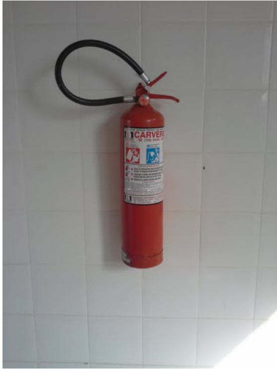
Descrição(5): Extintor de incêndio
