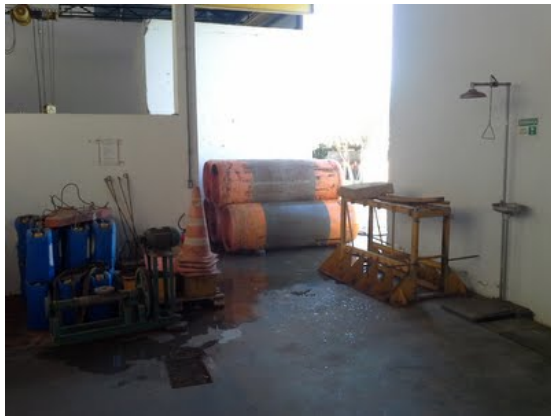
Descrição(6): Cilindros de Cloro e chuveiro de emergência
