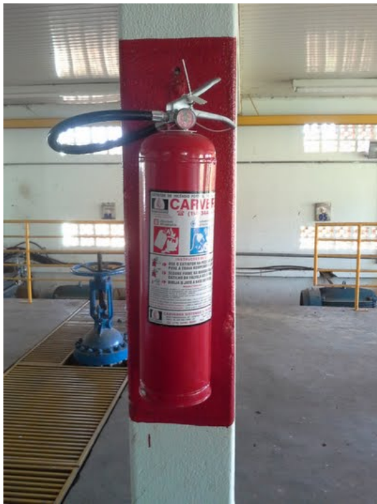
Descrição(6): Extintor de incêndio
