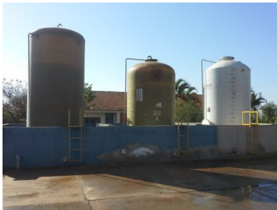
Descrição(8): Armazenamento de coagulantes
