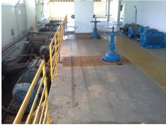
Descrição(5): Conjuntos de recalque em operação e reservas
