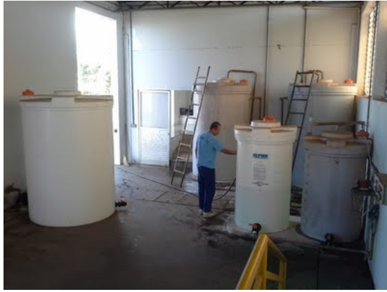
Descrição(7): Armazenamento de Fluor e alcalinizantes
