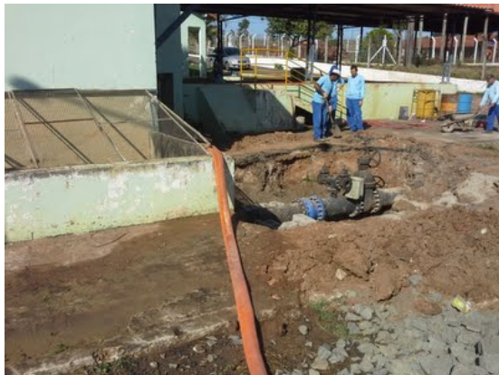
Descrição(4): Instalação de bomba anfíbia adicional para 100 L/s
