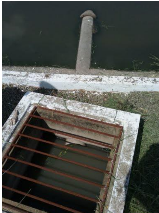
Descrição(7): Última caixa de passagem antes do tratamento na lagoa anaeróbia
