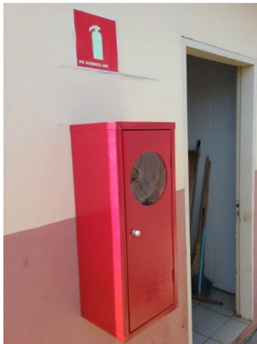
Descrição(3): Extintor de incêndio recentemente instalado.
