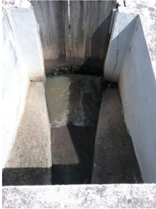
Descrição(6): Caixa de passagem de distribuição, situada entre o tratamento preliminar e a primeira lagoa de tratamento anaeróbia
