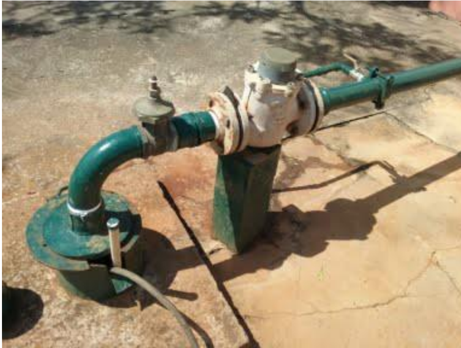
Descrição(2): Vista em detalhe do cavalete com todos os equipamentos do poço Campo I.
