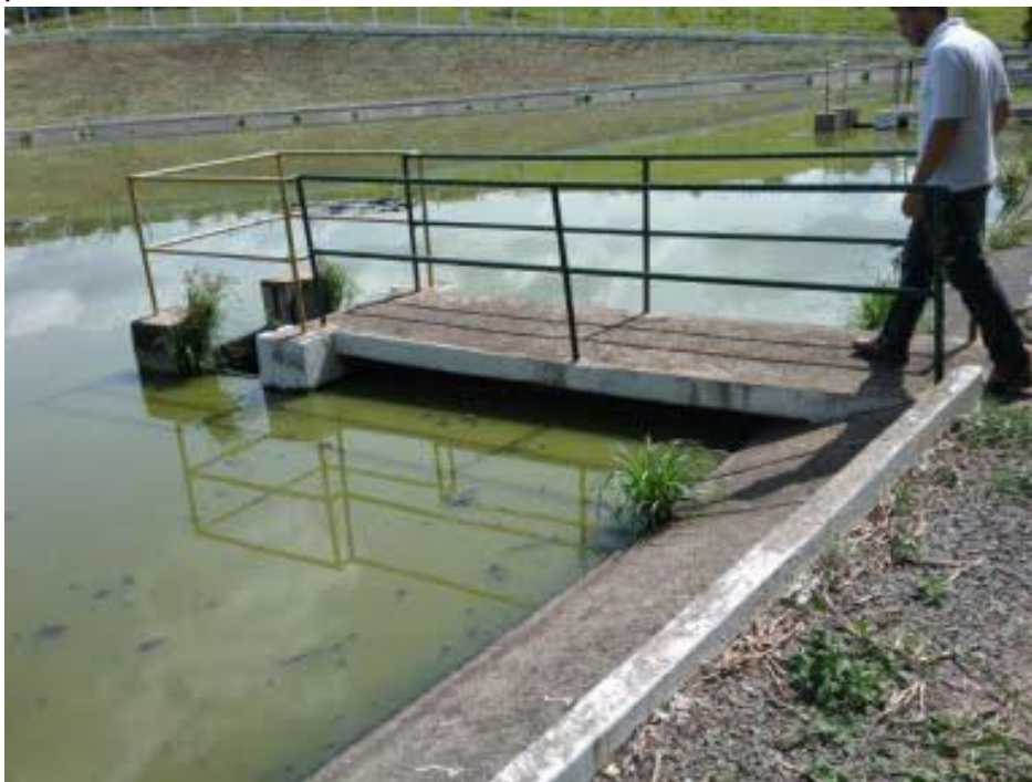
Descrição(11): Plataforma de acesso a um dos dois vertedores de saída do esgoto tratado da lagoa facultativa
