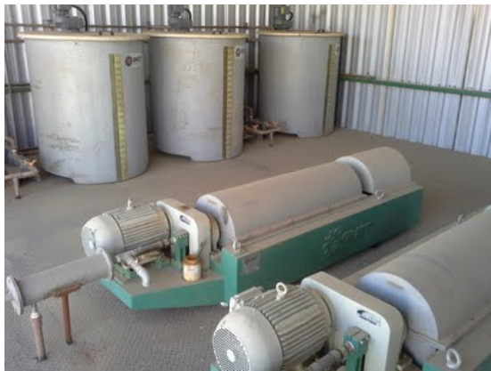
Descrição(4): Casa desidratação do lodo
