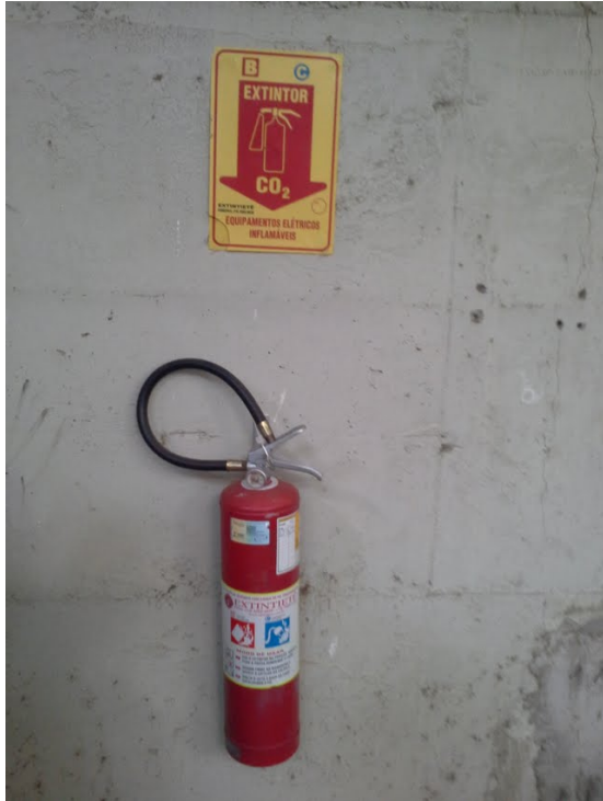
Descrição(2): Extintor de incêndio
