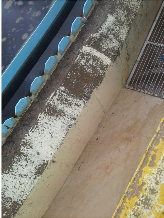
Descrição(4): Saída do efluente do decantador
