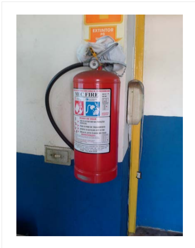
Descrição(2): Extintor de incêndio
