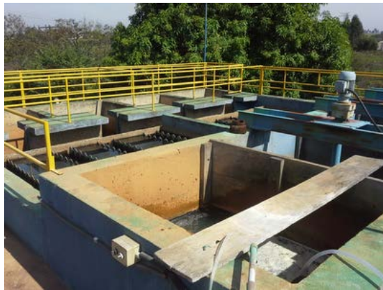
Descrição(3): Floculadores, decantadores e filtros
