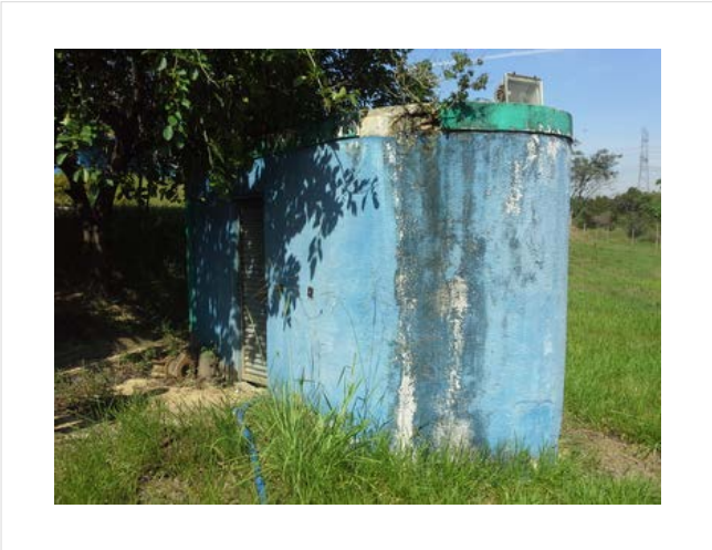
Descrição(3): Estação elevatória
