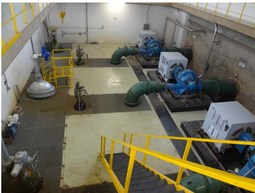
Vista da casa de bombas da Captação do Rio Atibaia
