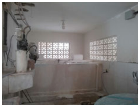
Descrição(4): Casa de Química (comum a todas as ETAs)
