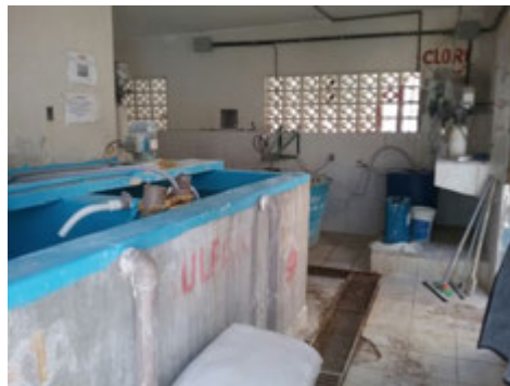
Descrição(3): Casa de química (comum a todas as ETAs)
