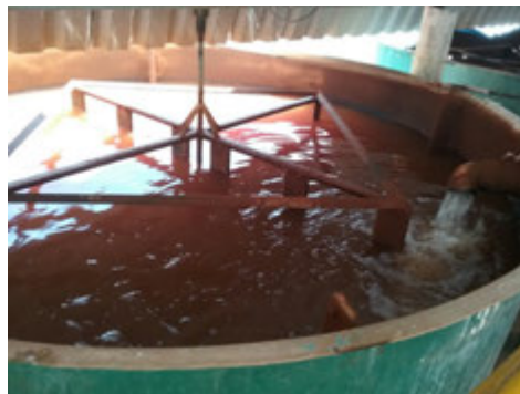
Descrição(3): FLOCULADOR - DECANTADOR
