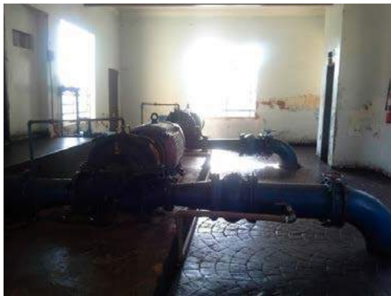
Descrição(4): Conjuntos de recalque
