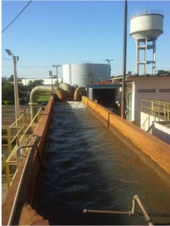
Descrição (7): Entrada água bruta
