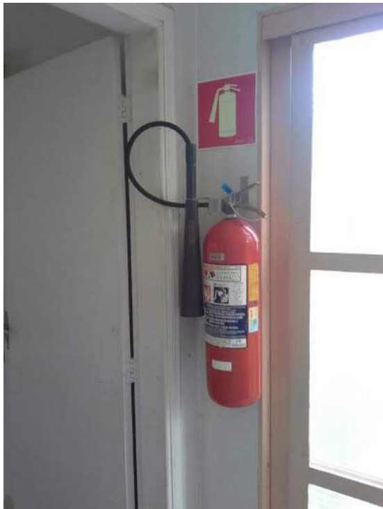
Descrição(3): Extintor incêndio
