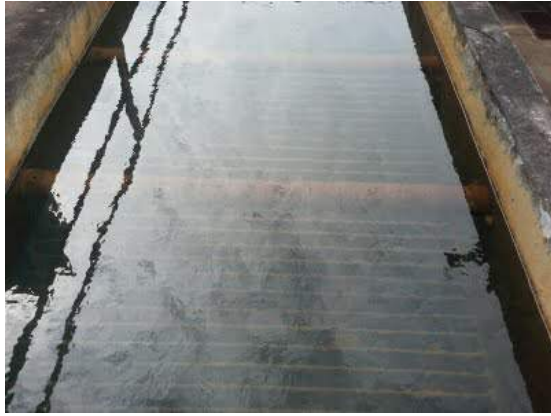
Descrição(8): Detalhe decantador
