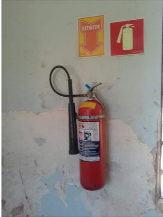
Descrição(5): Extintor de incêndio
