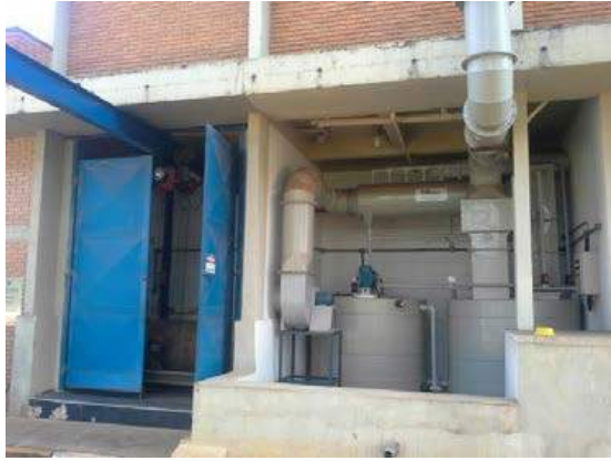
Descrição(1): Sistema de exaustão de gás cloro
