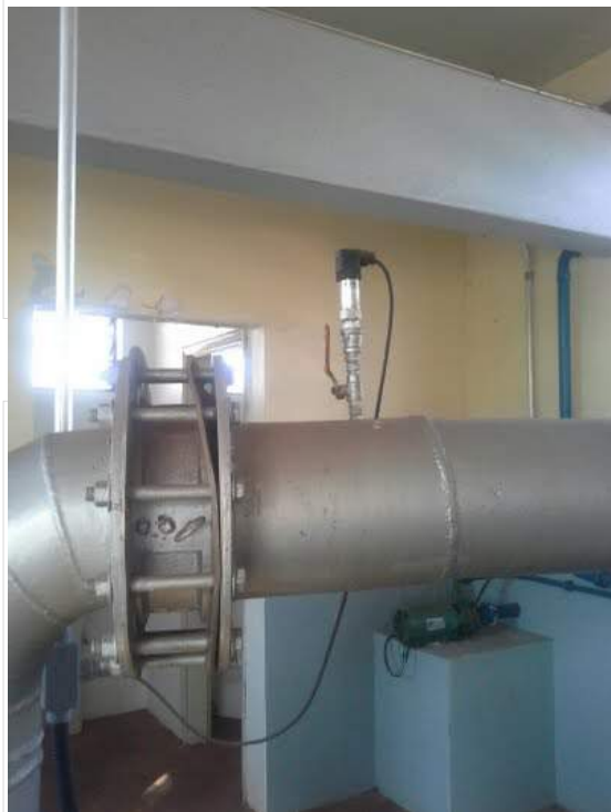
Descrição (4): Medidor de vazão
