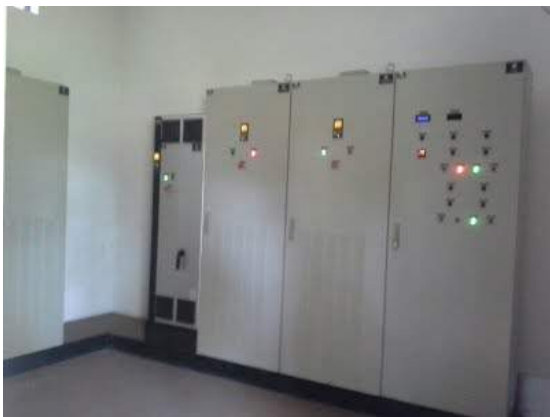
Descrição(1): Pannel elétrico
