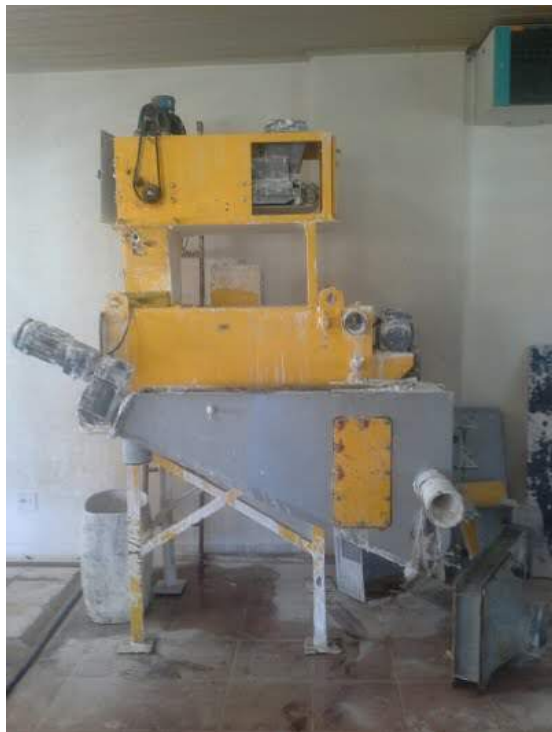
Descrição (4): Sistema antigo em processo desativação
