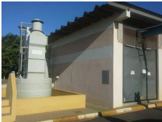
Descrição (6): Sistema de exaustão do gás cloro
