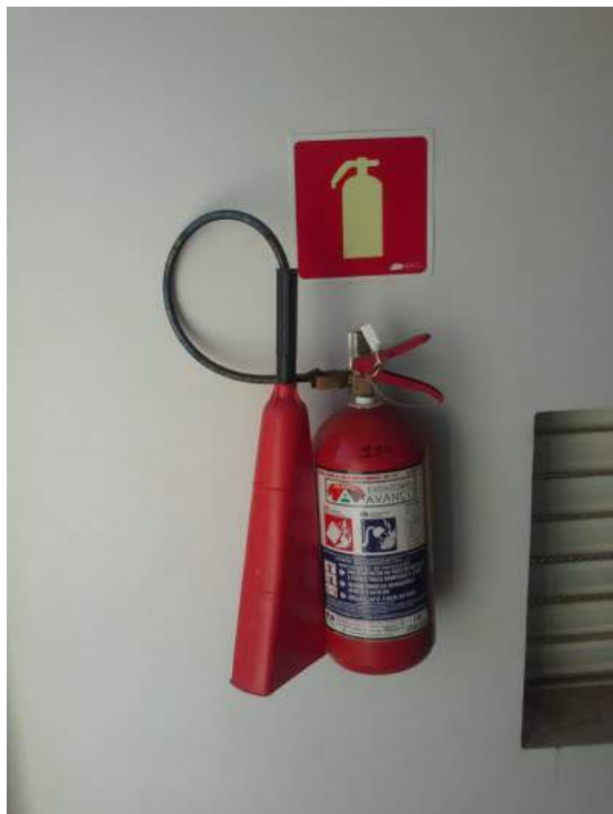
Descrição(3): Extintor de incêndio
