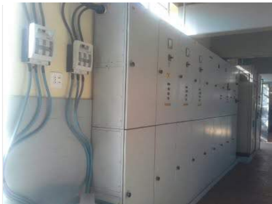
Descrição (3): Conjuntos de recalque
