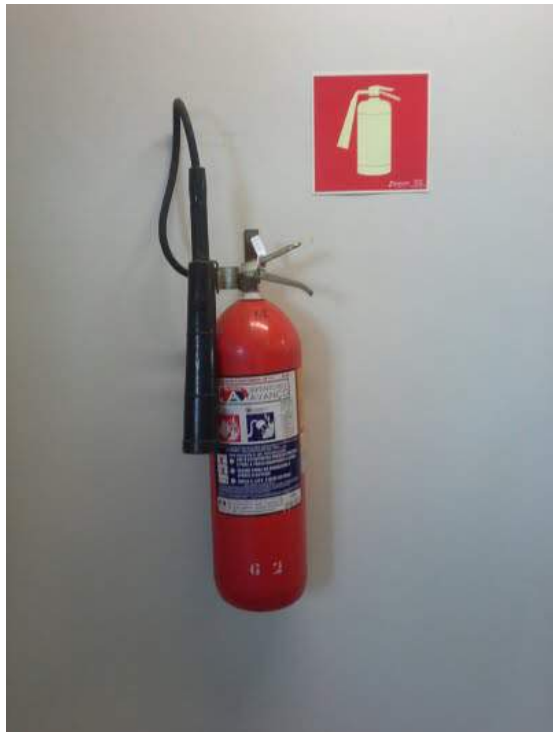
Descrição(11): Extintor incêndio
