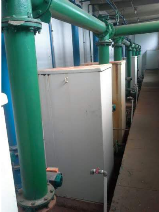
Descrição(14): Saída filtros
