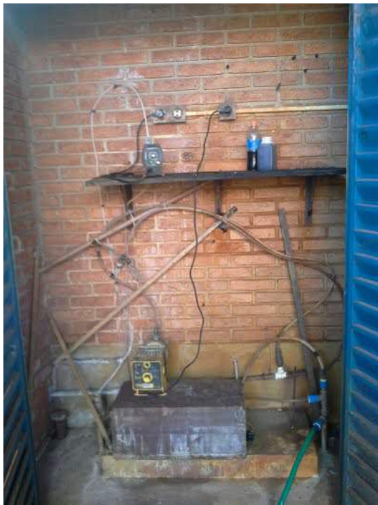
Descrição(13): Sistema de dosagem de flúor
