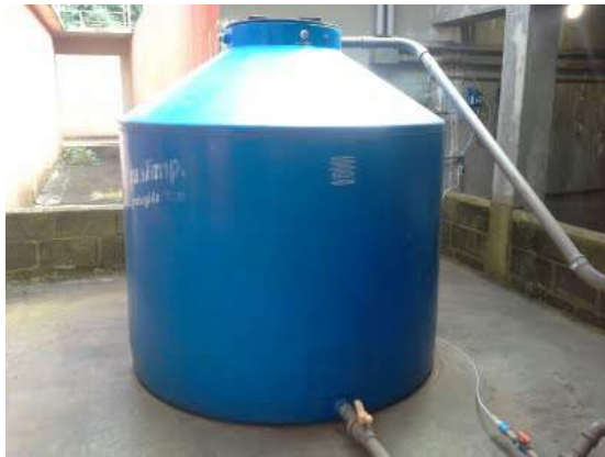
Descrição(15): Armazenamento de ortopolifosfato
