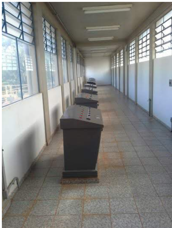
Descrição(10): Sala controle dos filtros
