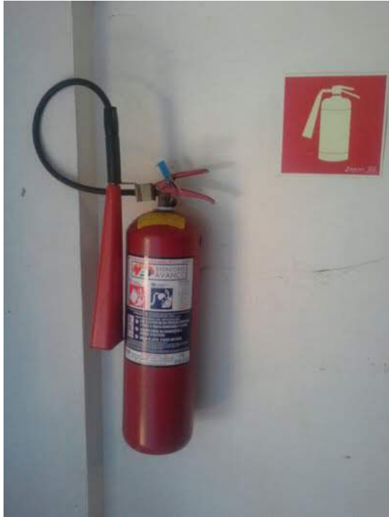
Descrição (5): Extintor de incêndio
