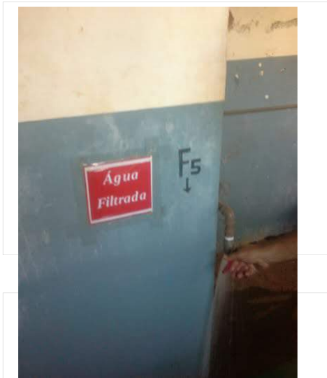
Descrição (12): Detalhe água filtrada
