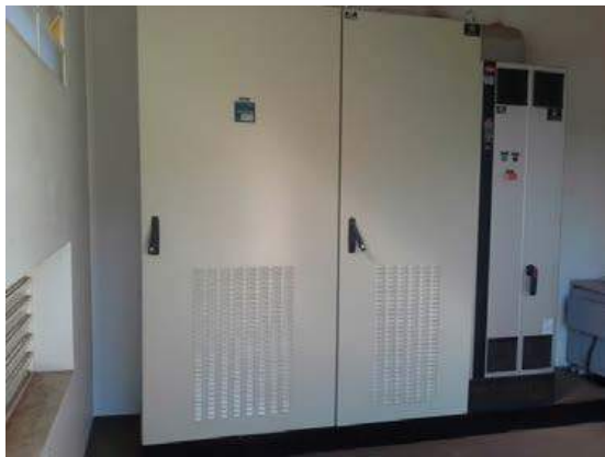
Descrição(2): Painel elétrico
