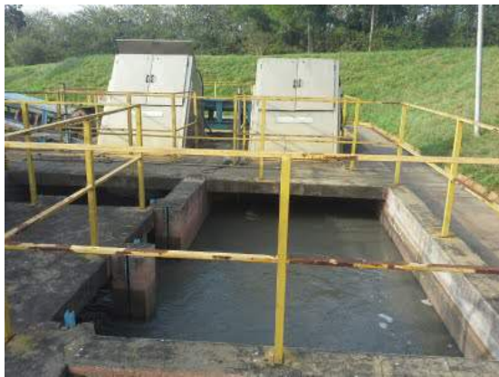
Descrição(11): Gradeamento fino
