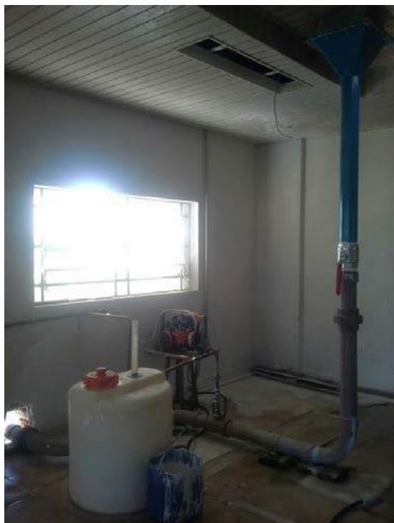
Descrição (3): Novo sistema de dosagem produto químico ( hidróxido de cal)
