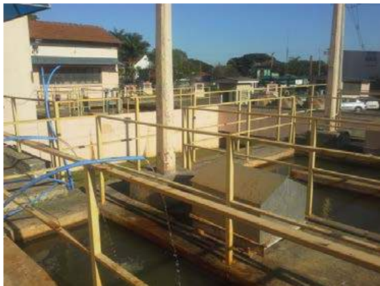
Descrição (8): Implantação de coleta de água tratada no laboratório da ETA
