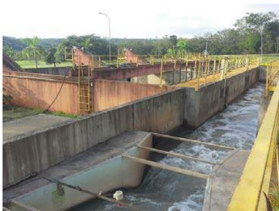
Descrição(9): Medidor de vazão
