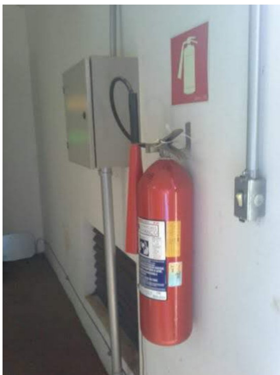
Descrição(2): Extintor de incêndio
