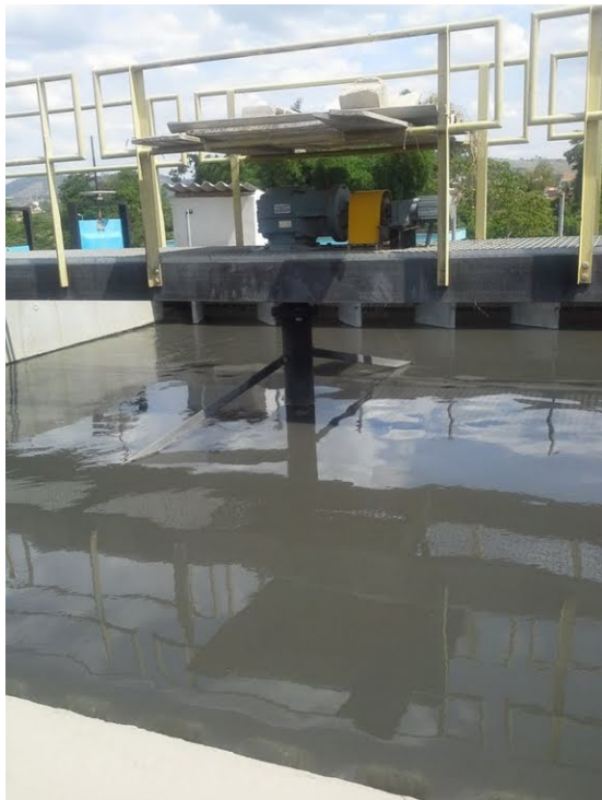
Descrição(5): Caixa de areia
