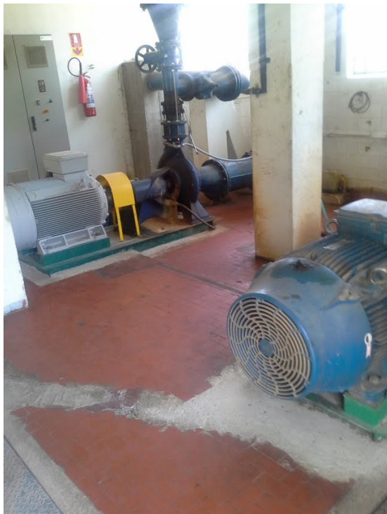
Descrição(3): Conjunto moto bomba
