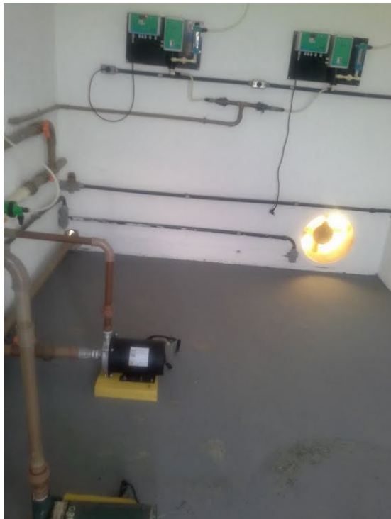
Descrição(7): Bombas gás cloro
