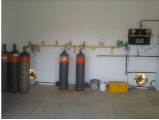
Descrição(8): Cilindros gás cloro
