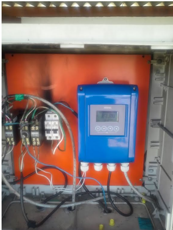
Descrição(11): Macromedidor saída
