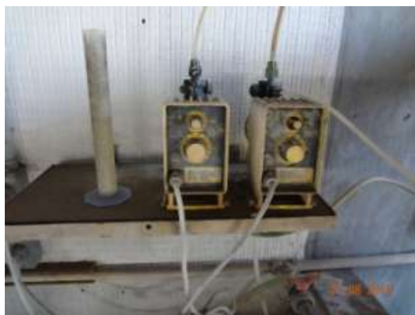
Figura 50 - Bomba dosadora de Flúor
