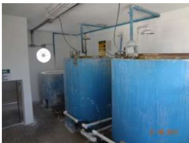
Figura 27 - Casa de química - Aplicação de cal
