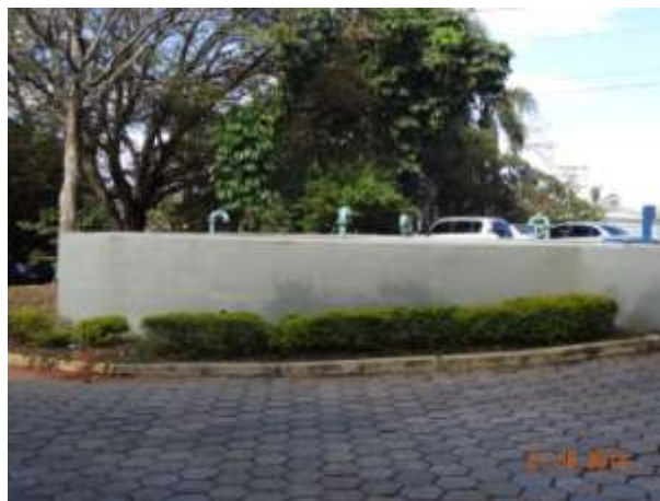
Figura 54 - Reservatório de distribuição semi-enterrado
