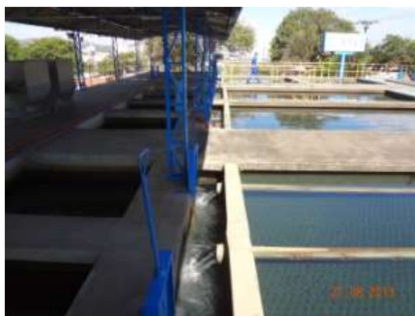
Figura 44 - Passagem do decantador para o filtro
