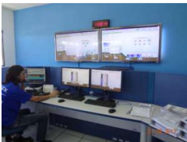
Figura 80 - Centro de controle Operacional (CCO)
