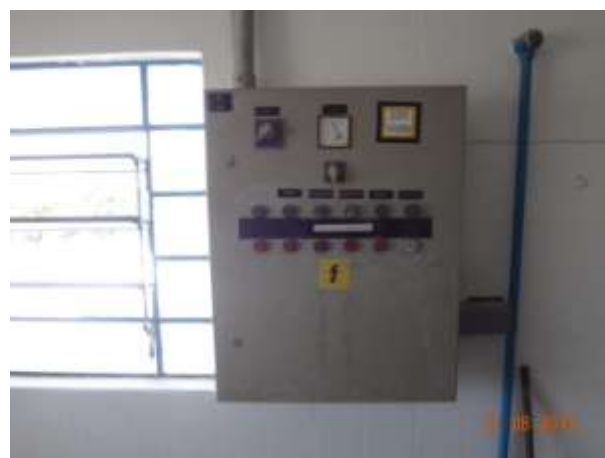
Figura 28 - Painelelétrico da casa de química
