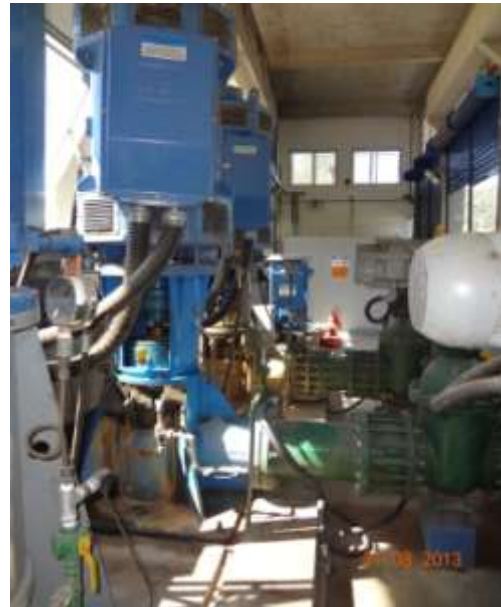
Figura 15 - Estação Elevatória de Água Bruta
