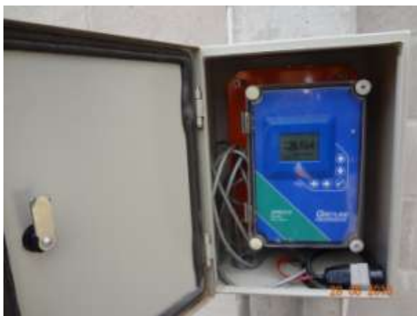
Figura 89 - Display do medidor de vazão
