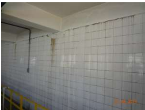
Figura 59 - Infiltração aparente nas instalações da EEAT
