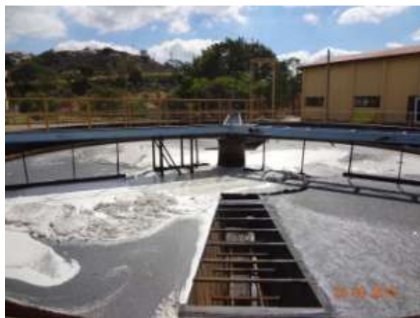
Figura 102 - Tanque de flotação
