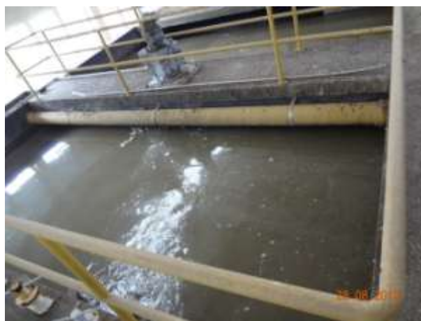
Figura 94 - Desarenador com raspador automático
