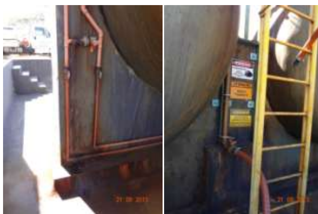
Figura 79 - Presença de vazamentos aparentes nas tubulações do tanque de Cloreto Férrico
