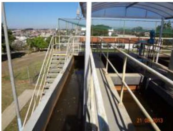
Figura 66 - Chegada da água por recalque para tratamento
