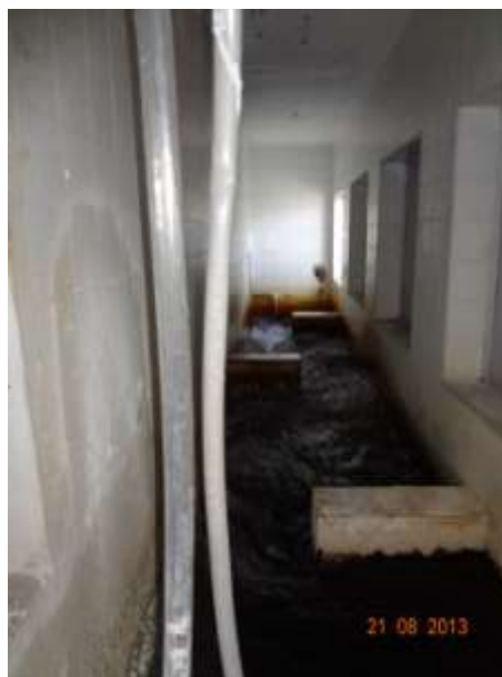
Figura 48 - Tanque de contato
