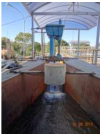
Figura 64 - Medidor Parshall ultrassônico
