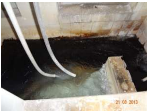
Figura 47 - Tanque de contato (aplicação de Cloro e Flúor)
