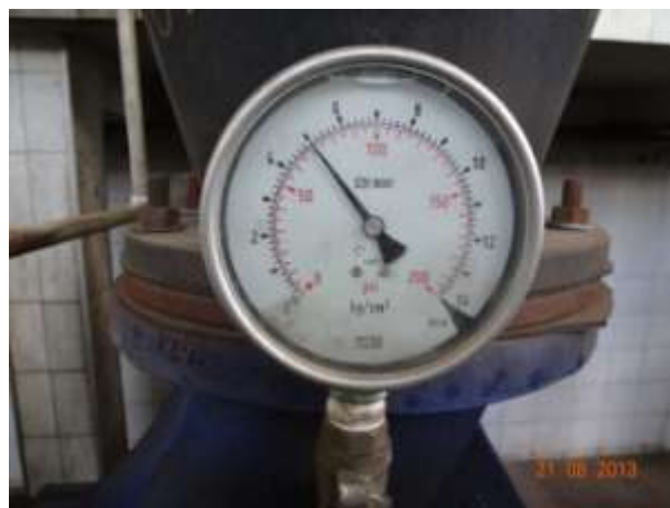
Figura 58 - Manômetro instalado em uma das bombas da EEAT
