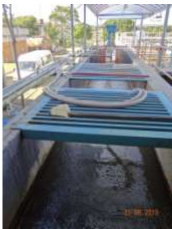
Figura 63 - Chegada da água bruta
