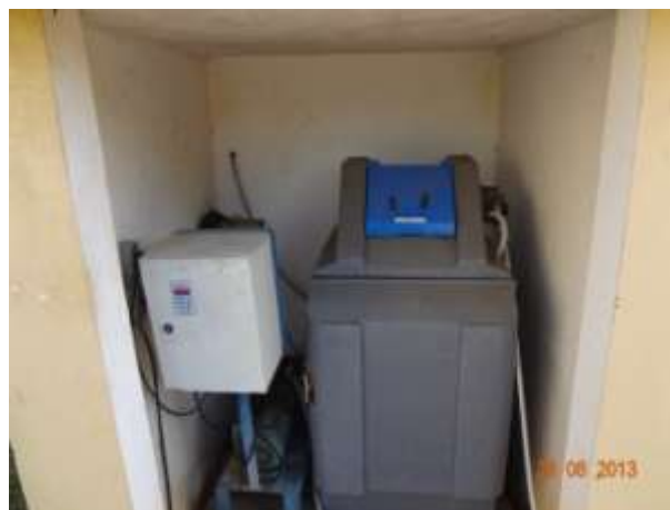
Figura 108 - Coletor automático localizado na saída do efluente
