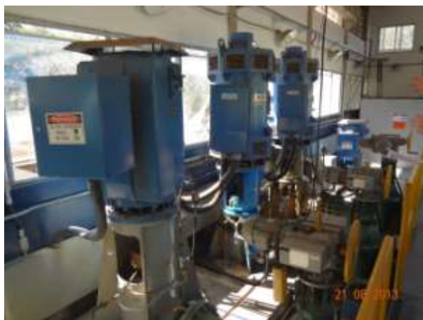
Figura 16 - Estação Elevatória de Água Bruta
