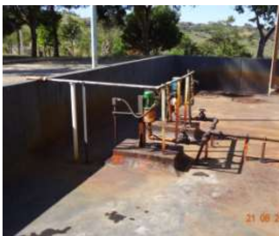
Figura 78 - Presença de vazamentos aparentes nas tubulações do tanque de Cloreto Férrico
