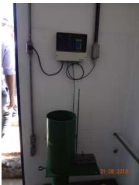
Figura 29 - Medidor Parshall da entrada da ETA
