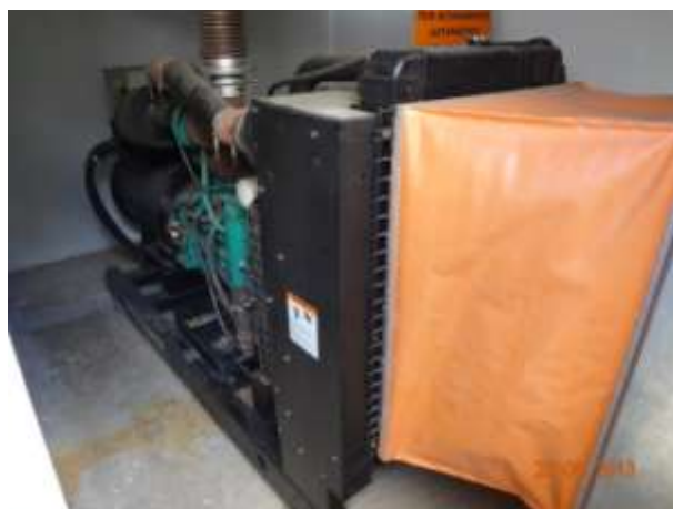
Figura 88 - Gerador com acionamento automático para casos de queda de energia
