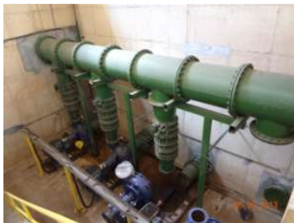
Figura 86 - Estação elevatória para recalque do efluente a peneira rotativa e desarenador
