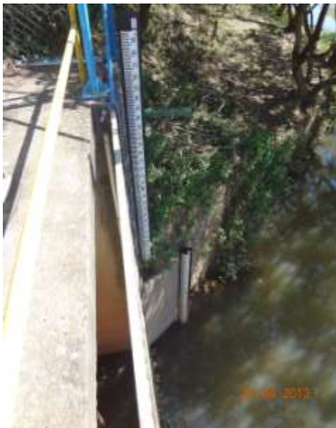
Figura 8 - Tomada de água da captação
