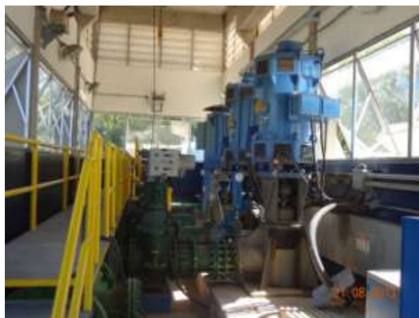
Figura 17 - Estação Elevatória de Água Bruta
