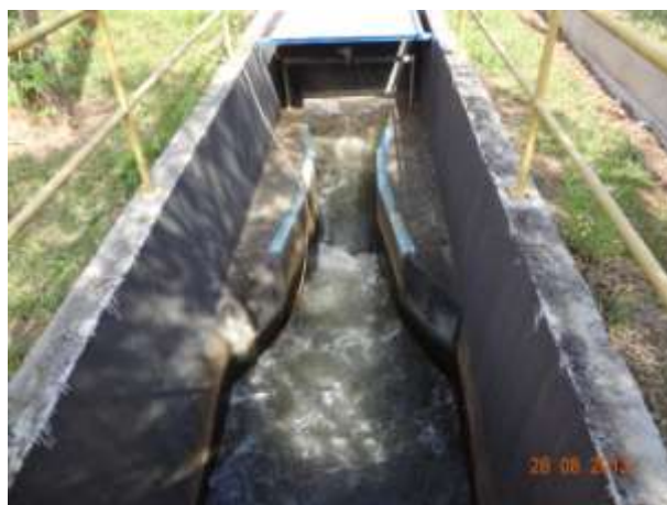
Figura 106 - Saída do efluente (com medidor ultrassônico)
