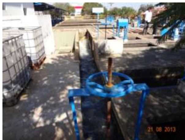
Figura 34 - Saída da calha Parshall e entrada nos floculadores
