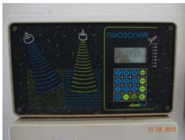
Figura 30 - Detalhe do medidor Parshall
