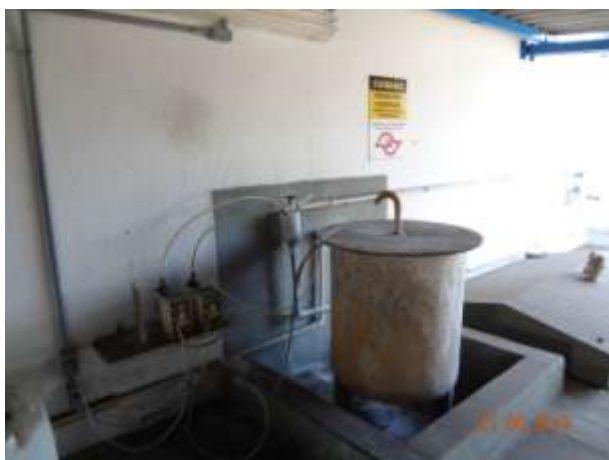
Figura 49 - Reservatório de aplicação do Flúor
