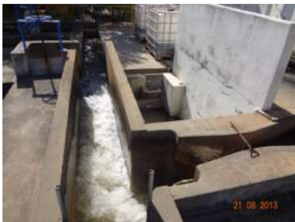
Figura 33 - Saída da calha Parshall e entrada nos floculadores
