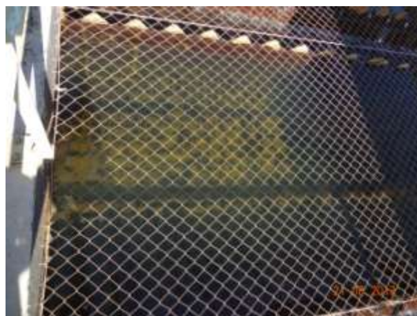
Figura 73 - Tanque de decantação
