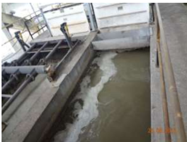
Figura 93 - Passagem pela grade fina (utilizada como reserva da peneira rotativa - manutenção)
