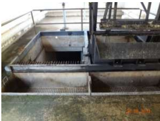
Figura 85 - Local de descarte dos resíduos grosseiros
