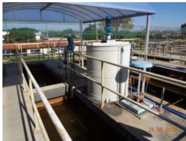
Figura 67 - Tanques de floculação
