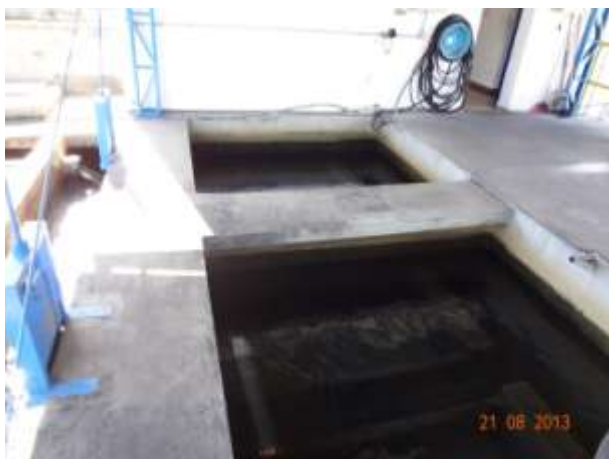
Figura 45 – Filtros (oito unidades)
