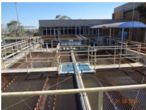
Figura 72 - Tanques de decantação com tela protetora
