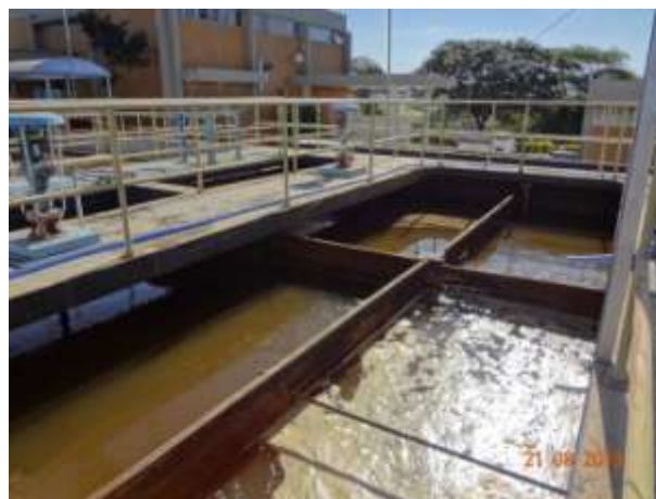
Figura 69 - Tanques de floculação
