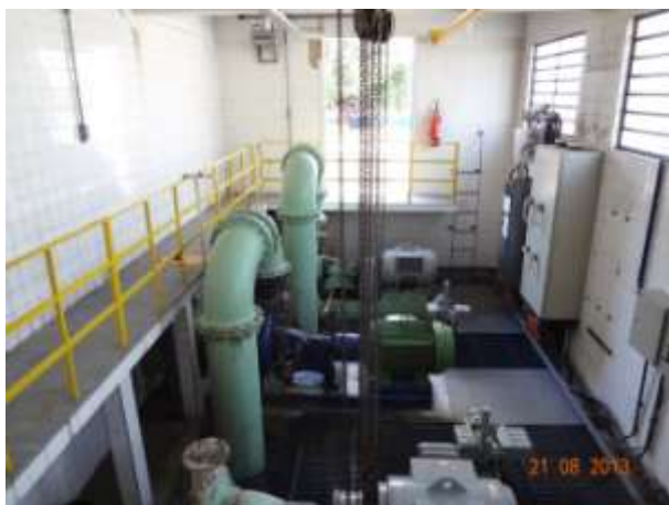
Figura 57 - Estação elevatória de Água Tratada
