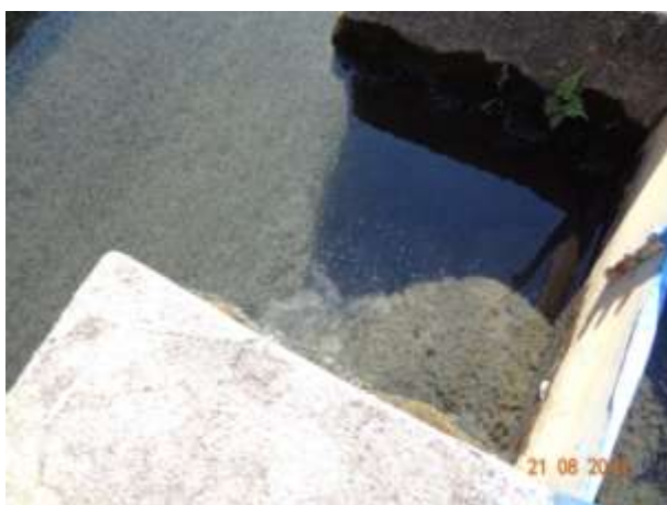
Figura 43 - Grande quantidade de flocos na entrada do sedimentador
